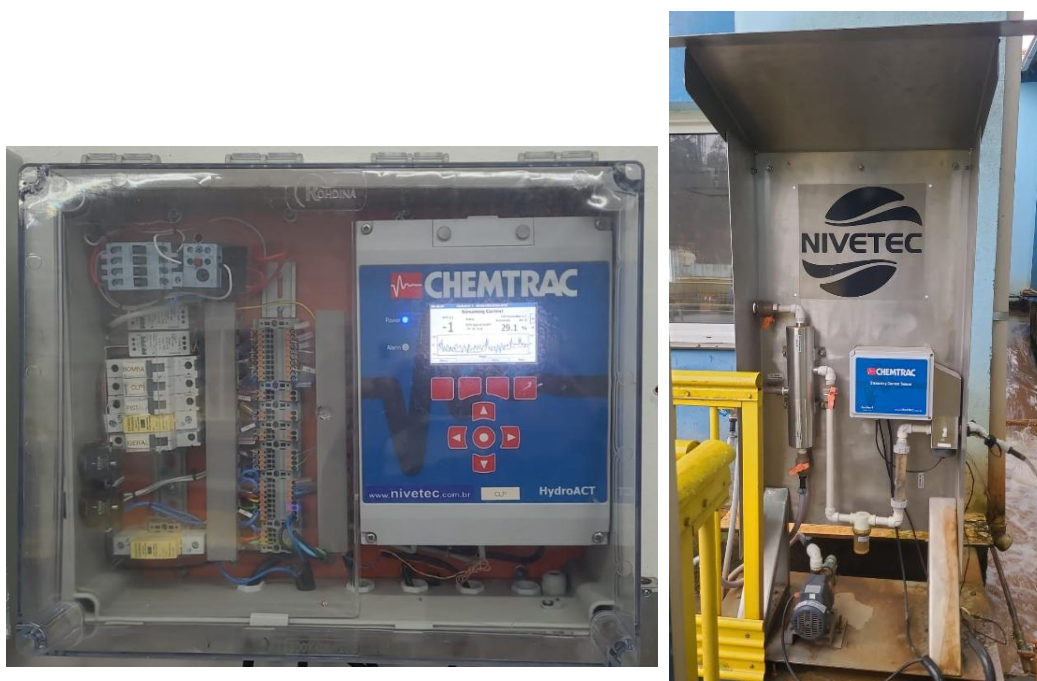
Figura 1. Sistema CHEMTRAC HydroACT instalado na ETA da COMUSA: (a) controlador eletrônico e (b) conjunto hidráulico e sensor.
