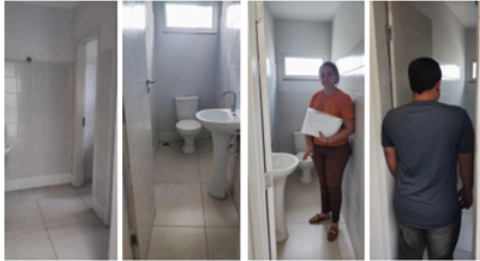
Banheiros (Masculino e Feminino) nos dois pavimentos, não condizendo com a acessibilidade
