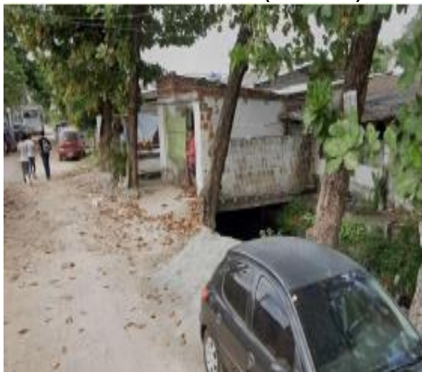
Figura 5: Edificação Construída Sobre o Canal da Mauricéia (Trecho 1)
