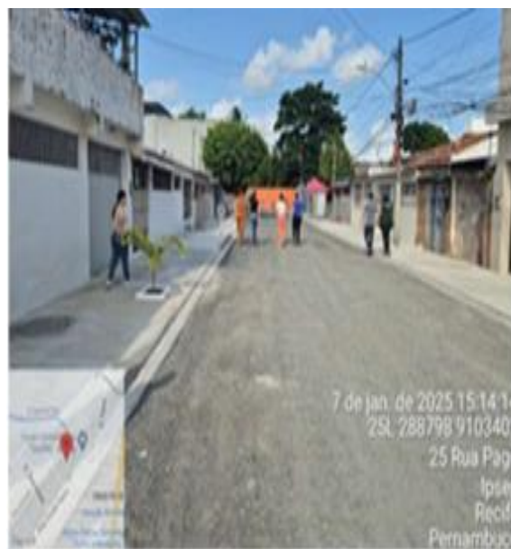
Figura 13: Rua Pagé com acesso ao canal bloqueado por muro (Trecho 2)
