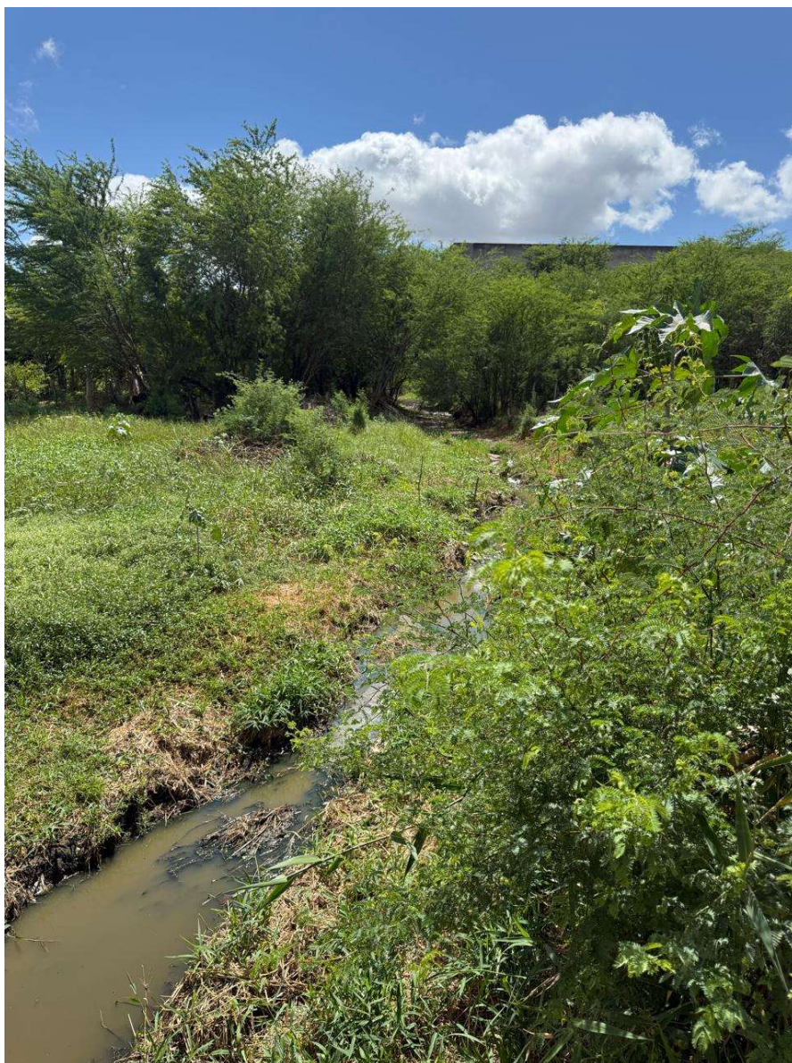
Figura 4-1 – Condições atuais da calha e das margens do canal
