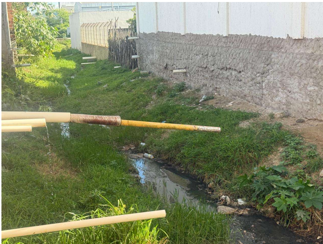
Figura 4-4 – Condições existentes de lançamento de águas residuárias na calha do canal
