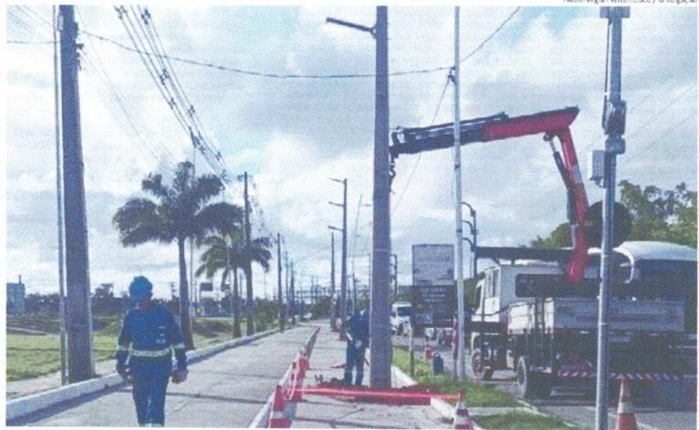
Neoenergia Pernambuco investe R$ 1,8 milhão em novo circuito para reforçar energia em Porto de Galinhas
