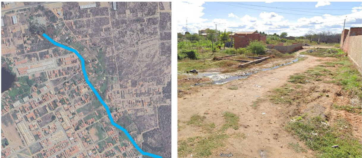
Figura 31. Trecho crítico no Riacho Pau Ferro com concentração de edificações irregulares sobre o talvegue natural
