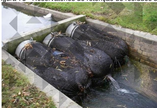
Figura 73 - Reservatórios de retenção de resíduos sólidos.
