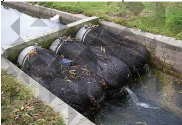
Figura 150 - Reservatórios de retenção de resíduos sólidos.
