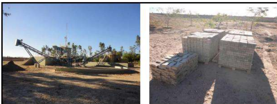
Figura 96 – Unidade de Beneficiamento de Entulho da CTR Petrolina.
