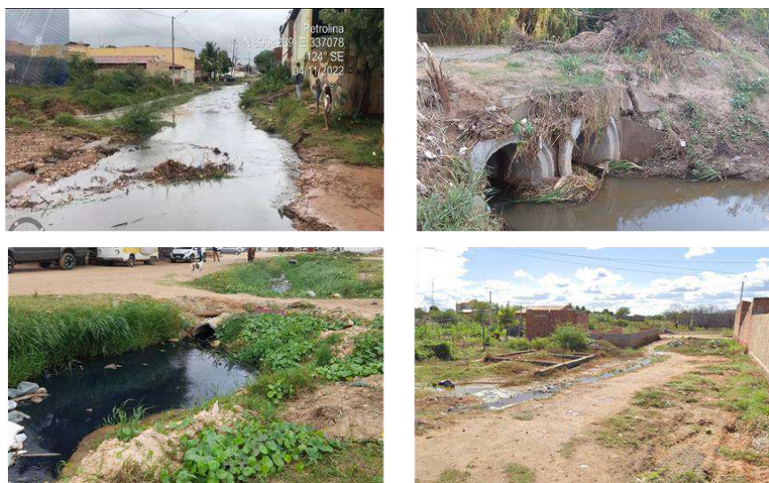
Figura 107. Problemas de macrodrenagem identificados.
