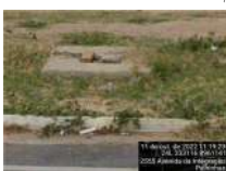
CAIXA DE PASSAGEM Nº: 01 E 333122 N 8961178 DISPOSITIVO SELADO
