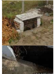
BOCA DE LOBO SIMPLES Nº: 01 E 334272 N 8960670 PROFUNDIDADE = 1,20 m AVALIAÇÃO EXPEDITA Condições do dispositivo Danificada (tampa) N Danificada (caixa) N Sedimentos S Entulho / Lixo S
