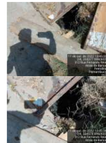
BOCA DE LOBO SIMPLES Nº: 02 E 334378 N 8960655 PROFUNDIDADE = 0,80 m AVALIAÇÃO EXPEDITA Condições do dispositivo Danificada (tampa) S Danificada (caixa) N Sedimentos S Entulho / Lixo S
