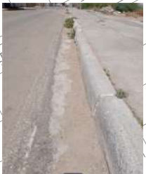
Meio-fio com sarjeta E 336306 N 8965434 Largura (LD) = 0,28 m AVALIAÇÃO EXPEDITA Condições do dispositivo █ Presença de sedimentos S Presença de entulho N Obstruções N
