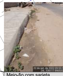
Meio-fio com sarjeta E 336117 N 8965326 Largura (LE) = 0,28 m AVALIAÇÃO EXPEDITA Condições do dispositivo █ Presença de sedimentos S Presença de entulho N Obstruções S
