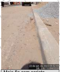
Meio-fio com sarjeta E 336116 N 8965328 Largura (LD) = 0,28 m AVALIAÇÃO EXPEDITA Condições do dispositivo █ Presença de sedimentos S Presença de entulho S Obstruções N
