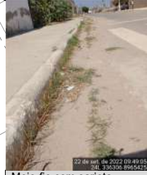
Meio-fio com sarjeta E 336306 N 8965425 Largura (LE) = 0,28 m AVALIAÇÃO EXPEDITA Condições do dispositivo █ Presença de sedimentos S Presença de entulho N Obstruções S
