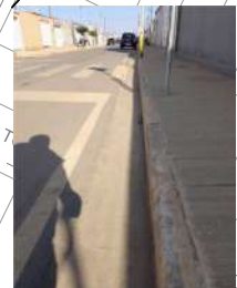
Meio-fio com sarjeta E 336964 N 8964598 Largura (LD) = 0,40 m AVALIAÇÃO EXPEDITA Condições do dispositivo ■ Presença de sedimentos N Presença de entulho N Obstruções N
