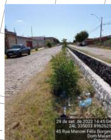
Ausência de linha d'água E 335033 N 8962625
