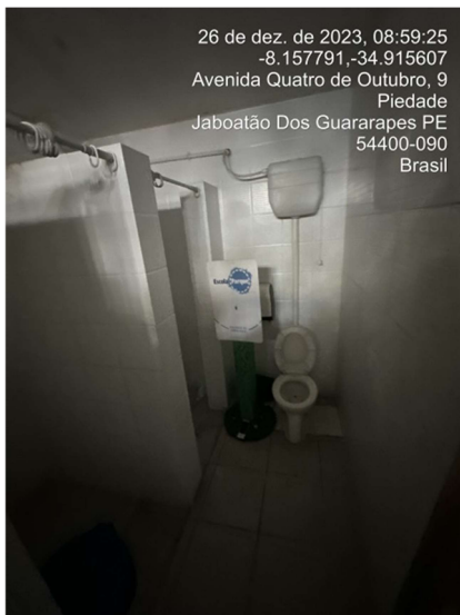
Figura 10 – Iluminação deficiente no banheiro infantil. Fonte: Gerência de Engenharia, 2024.
