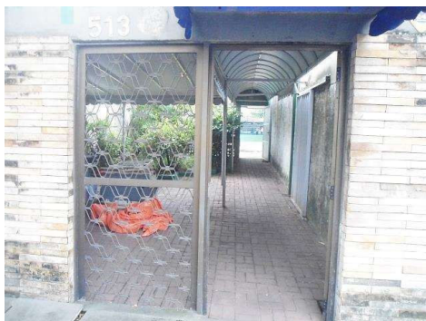
Figura 17 – Desnível entre calçada e hall de entrada. Fonte: Gerência de Engenharia, 2024.
