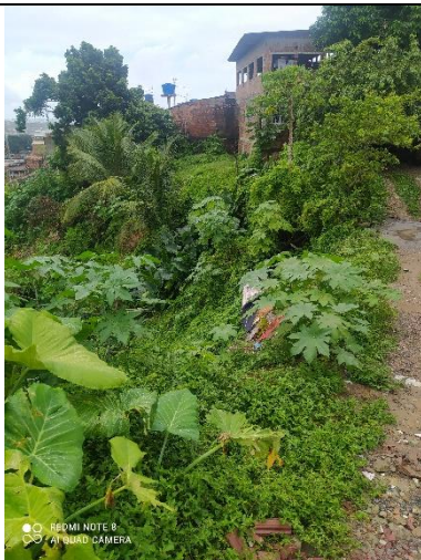
Figura 09: VEGETACAO SOBRE TALUDE
