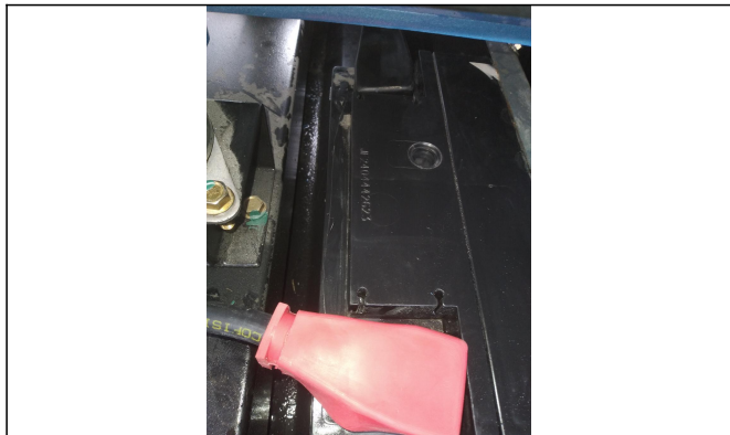
Banco de Bateria do grupo Gerador Instalada.
