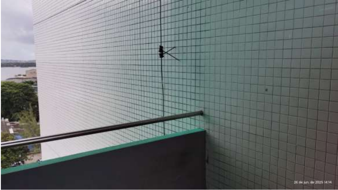
Figura 29- ADEQUAR GUARDA-CORPO PARA ALTURA COMPATÍVEL DE ACORDO COM A NORMA.
