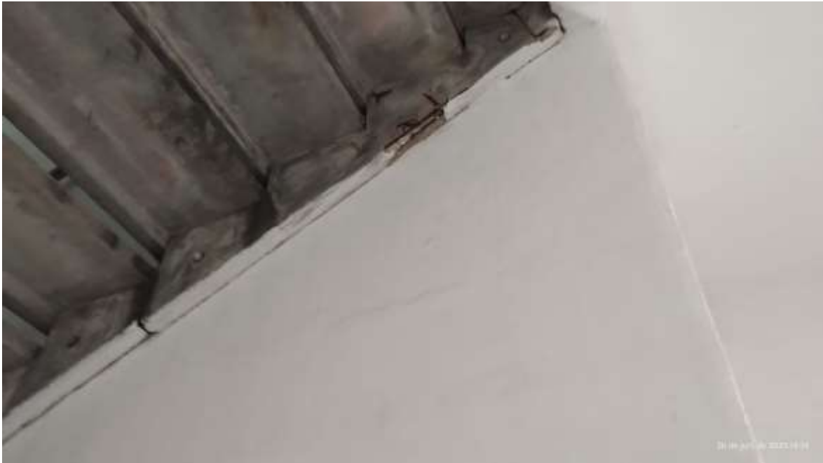
Figura 27- DETALHE DE PERDA DE RESISTÊNCIA DE MATERIAIS POR CORROSÃO NAS FERRAGENS DOS DEGRAUS.
