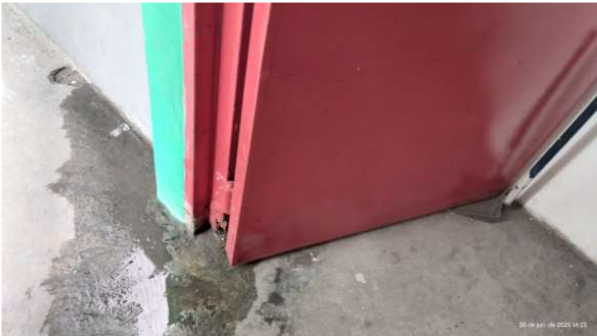
Figura 22-DETALHE ALAGAMENTO E DETERIORAÇÃO PORTA TIPO PCF.
