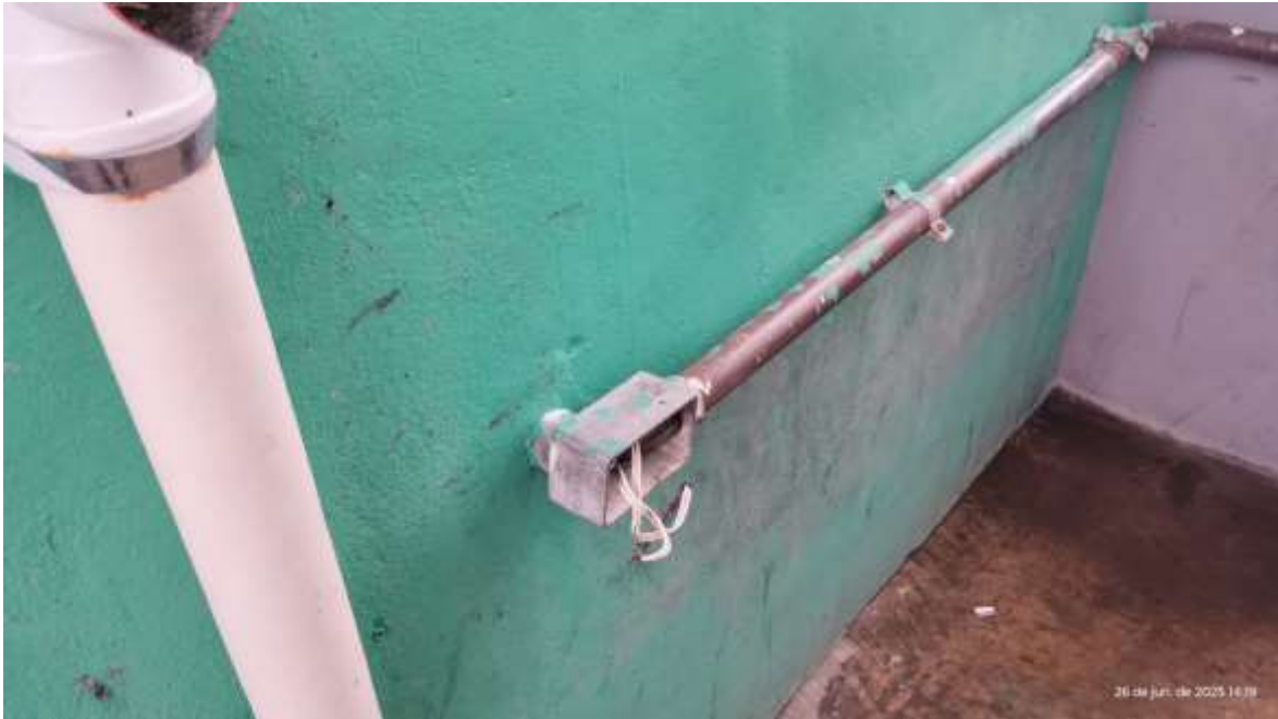
Figura 13-INSTALAÇÕES ELÉTRICAS INADEQUADAS NA VARANDA(ANTECÂMERA) -ADEQUAR CONFORME NORMA, E ACÚMULO DE ÁGUA NO PISO, NÃO É PERMITIDO UTILIZAR LOCAL COMO FUMODROMO, IMPERMEABILIZAR, COMPATIBILIZAR O ESCOAMENTO CORRETO DE ÁGUA ACUMULADA EM RALOS APROPRIADOS.
