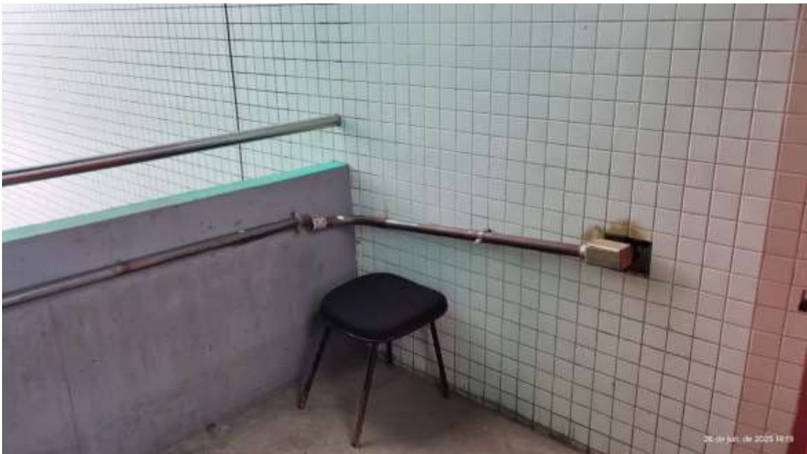
Figura 24-DETALHE DE OBJETOS NA VARANDA DE ACESSO A ESCADA (ANTECÂMERA) O QUE NÃO É PERMITIDO, LOCAL NÃO PODE SER UTILIZADO PARA OUTRAS ATIVIDADES QUE NÃO SEJAM A ROTA DE FUGA, NÃO É PERMITIDO PERMANENCIA DE PESSOAS NO LOCAL ( EXEMPLO: UTILIZAR LOCAL COMO FUMODROMO).
