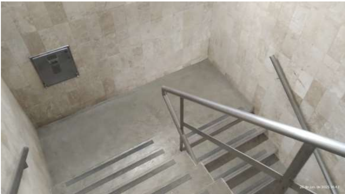
Figura 10- CORRIMÕES NÃO CONTÍNUOS E COM DEPÓSITO PARA LIXO, ADEQUAR ESCADA INTERNA.
