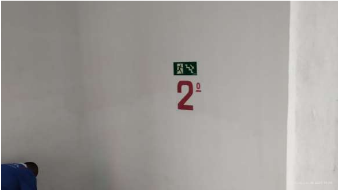
Figura 9-SINALIZAÇÃO INADEQUADA - SUBSTITUIR POR MATERIAIS DE ACORDO COM A NORMA PERTINENTE.
