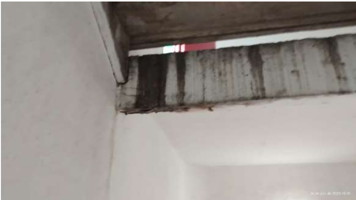
Figura 28-DETALHE INFILTRAÇÃO INTERNA NAS ESCADAS ( REALIZAR MANUTENÇÃO E IMPERMEABILIZAÇÃO).
