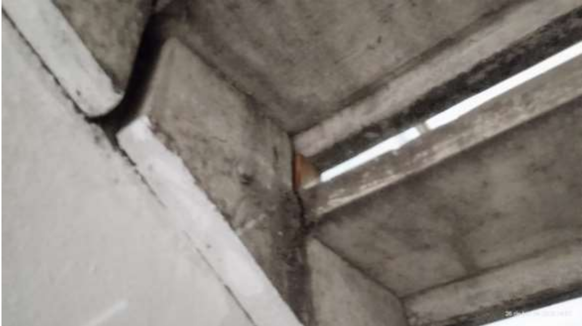
Figura 7-DETALHE CALÇO DE MADEIRA NA ESCADA DE EMERGÊNCIA ( FIXAR OS DEGRAUS ADEQUADAMENTE E RECUPERAR OU SUBSTITUIR DEGRAUS E PISOS DETERIORADOS).
