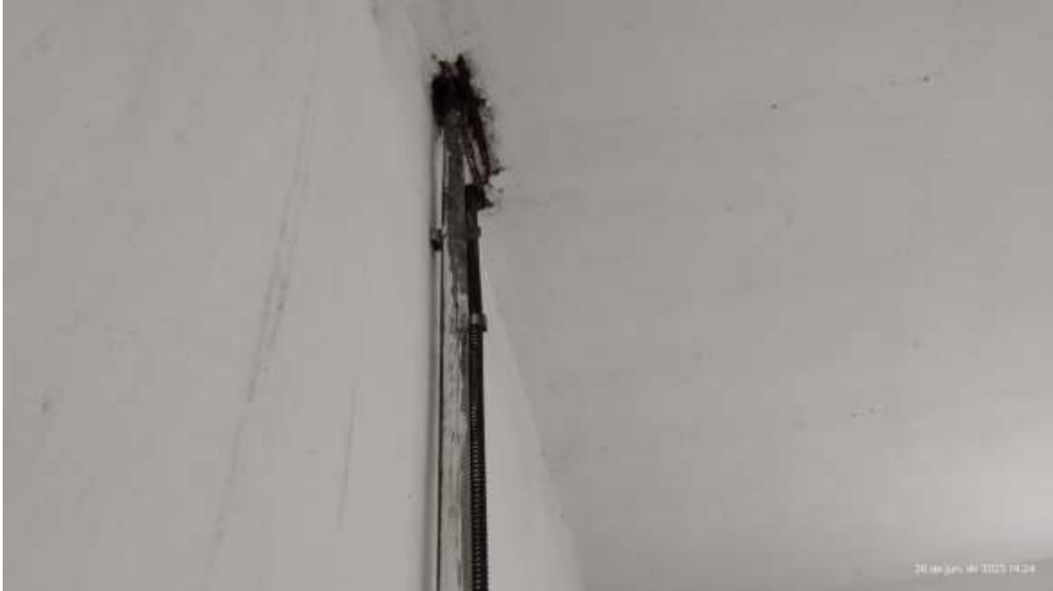
Figura 23-DETALHE INSTALAÇÃO ELÉTRICA DENTRO DA CAIXA DE ESCADA - O QUE NÃO É PERMITIDO ( EMBUTIR).
