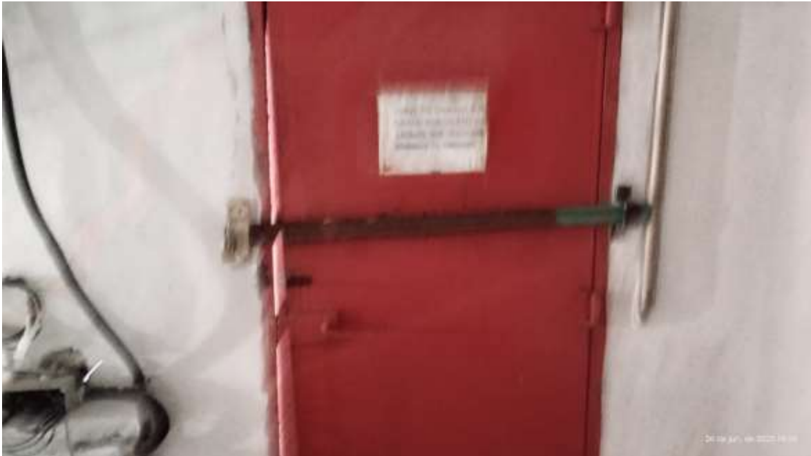
Figura 19-ACESSO AO HELIPONTO OBSTRUÍDO POR CADEADO - DESIMPEDIR ACESSO (PODERÁ SER INSTALADO ALTERNATIVAS COMO UM SISTEMA DE CFTV E ALARME NESTE LOCAL).
