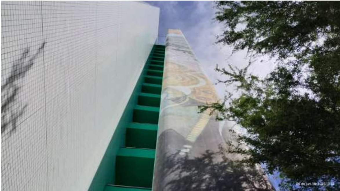
Figura 17-DETALHE DAS VARANDAS DE ACESSO A ESCADA EXTERNA, GUARDA CORPO INSUFICIENTE DE ACORDO COM A NORMA( COMPATIBILIZAR).
