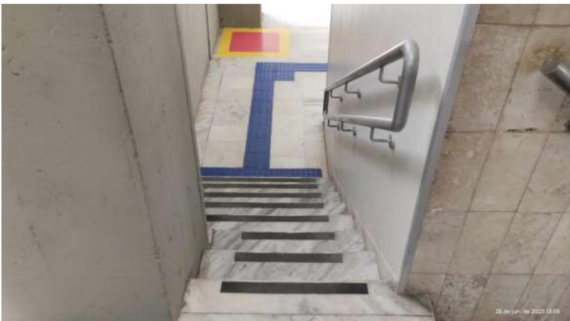
Figura 16-ESTREITAMENTO DA SAÍDA DE EMERGÊNCIA NO PISO DE DESCARGA, COMPATIBILIZAR DE ACORDO COM A NORMA.
