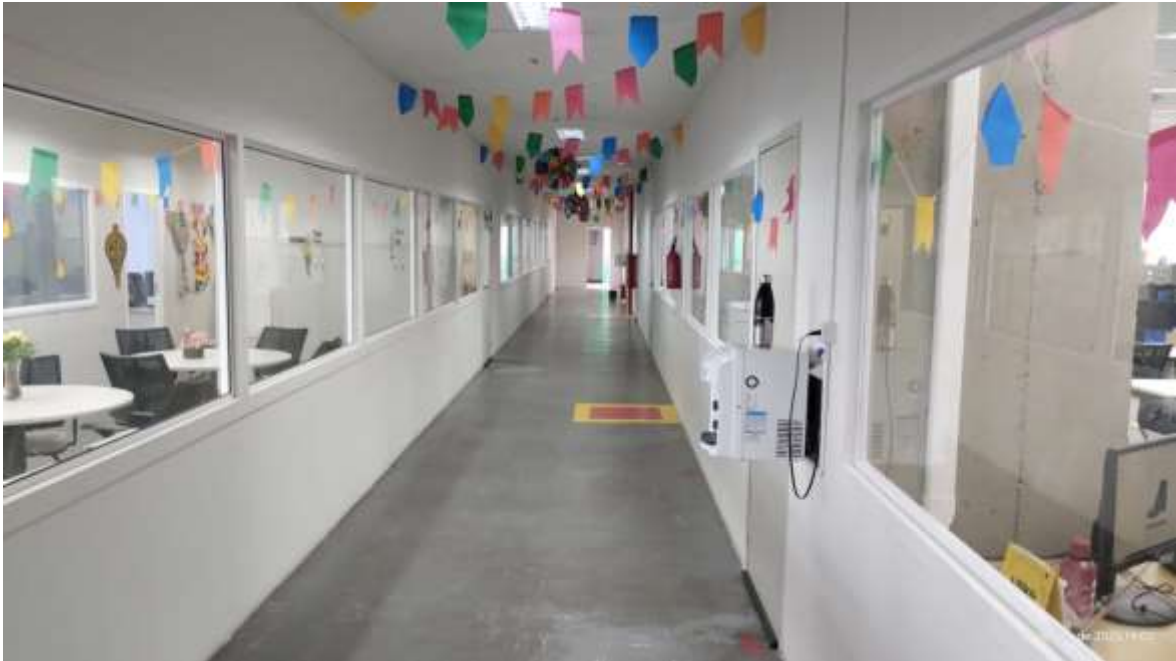
Figura 15-DETALHE DO ACESSO A ESCADA: AUSENCIA DE SISTEMAS DE SINALIZAÇÃO, CHUVEIROS AUTOMÁTICOS E ILUMINAÇÃO DE EMERGÊNCIA.
