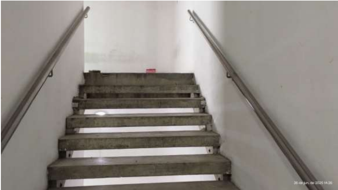
Figura 21-REALIZAR MANUTENÇÃO DOS DEGRAUS E COMPATIBILIZAR CORRIMÕES DE ACORDO COM A NORMA.
