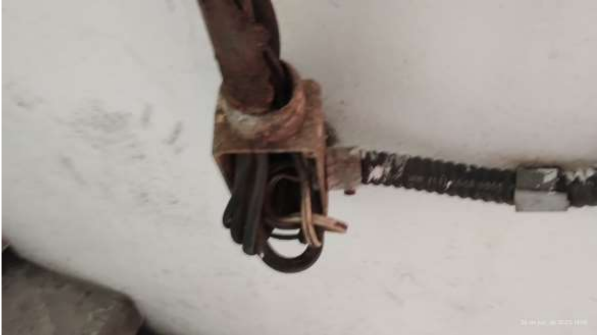
Figura 25-DETALHE INSTALAÇÃO ELÉTRICA INADEQUADA NA CAIXA DE ESCADA( ADEQUAR E EMBUTIR).
