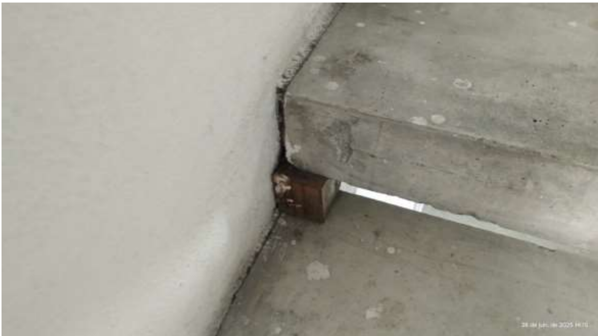
Figura 26-DETALHE CALÇO INADEQUADO NOS DEGRAUS, FIXAR TODOS OS DEGRAUS DE FORMA ADEQUADA E SUBSTITUIR OS DEGRAUS DETERIORADOS.
