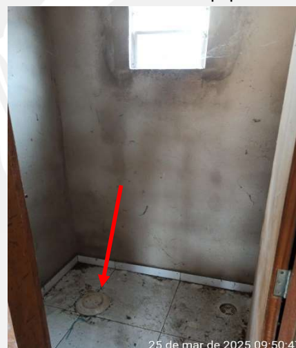
Foto 16 – Banheiros sem equipamentos
