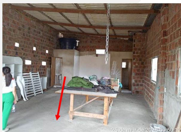
Foto 13 – Ambientes sem revestimentos
