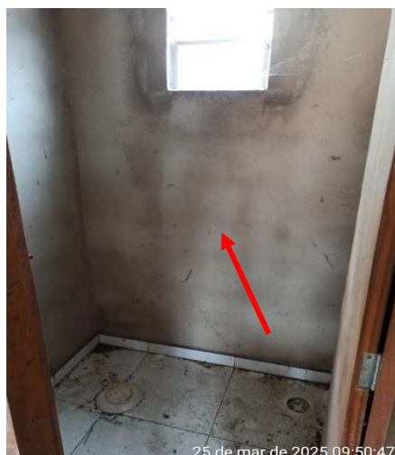
Foto 15 – Banheiro sem revestimento
