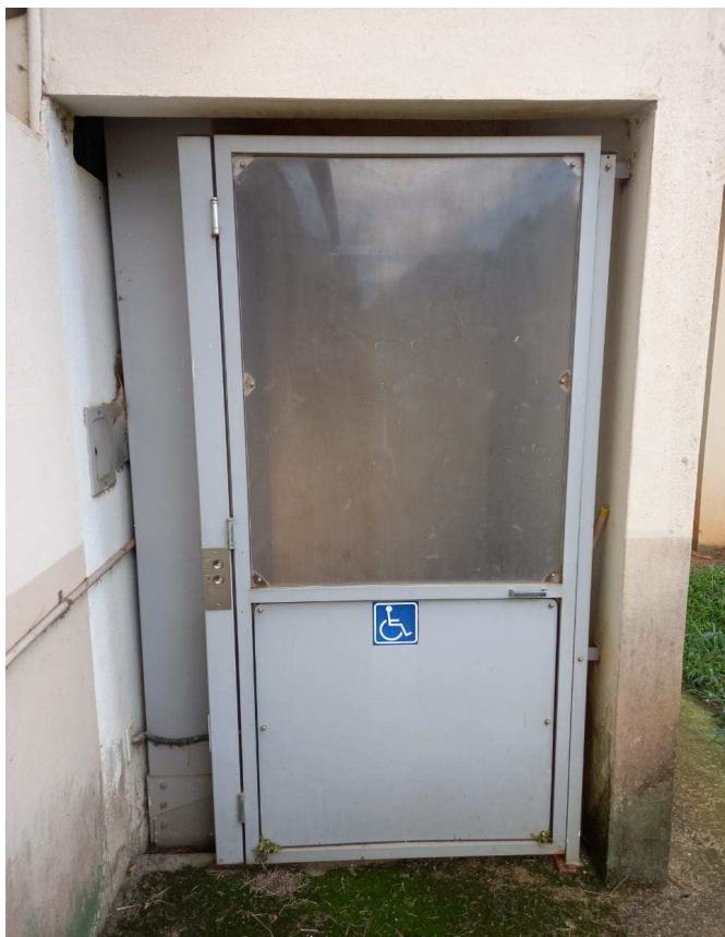
Fig. 01: Situação atual, portão de pavimento.
