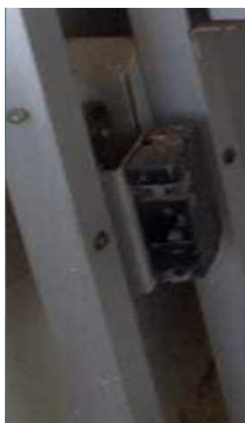
Fig. 03: Situação atual, sistema de fecho sem trincado.
