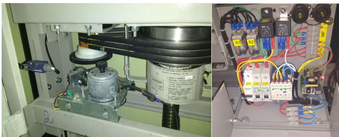
Fig. 08: Situação ideal, sistema de resgate automático instalado.
