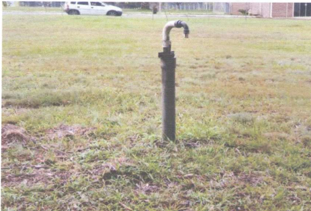
Figura nº 04 – Poço Desativado. Vista do poço subterrâneo desativado.
