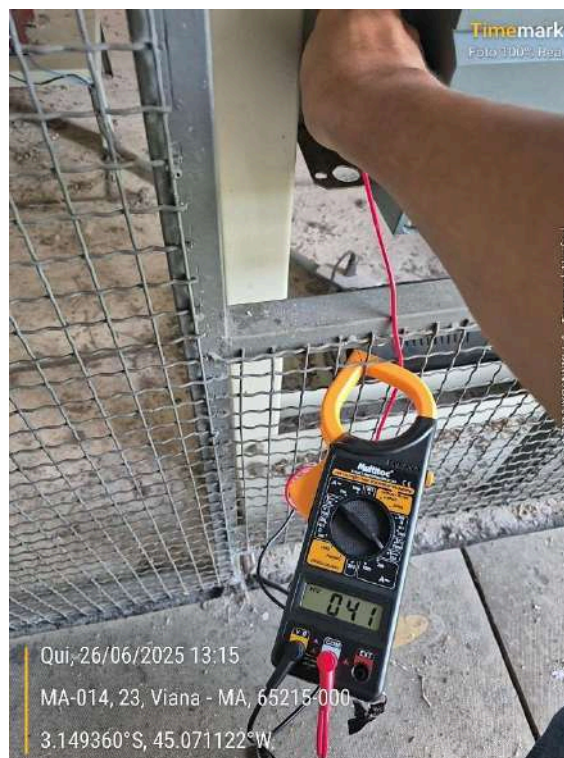
Foto 10 – CABINE CARCAÇA DISJUNTOR
