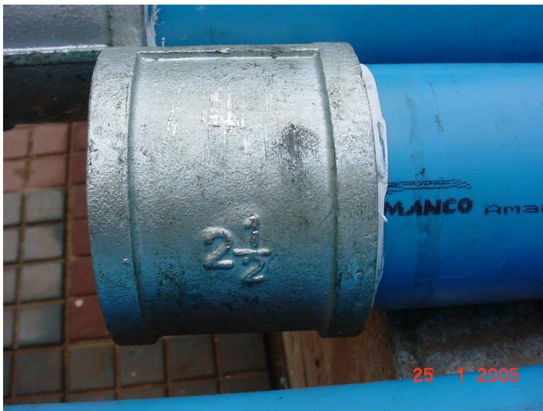
Figura 3: Tubulação de recalque em PVC de 2½ polegadas utilizada no sistema de bombeamento.
