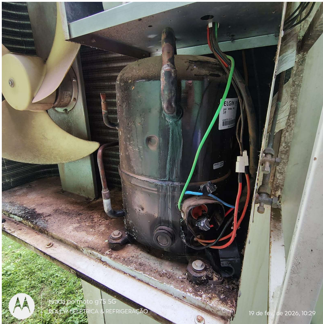
Foto 3 – Compressor 3hp, trifásico. (equipamento 01)
