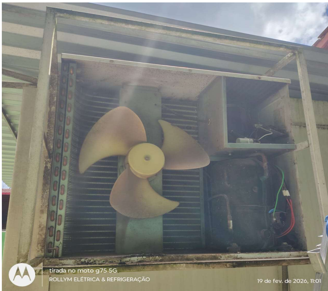
Foto 1 – Visão geral da unidade condensadora. (equipamento 01)
