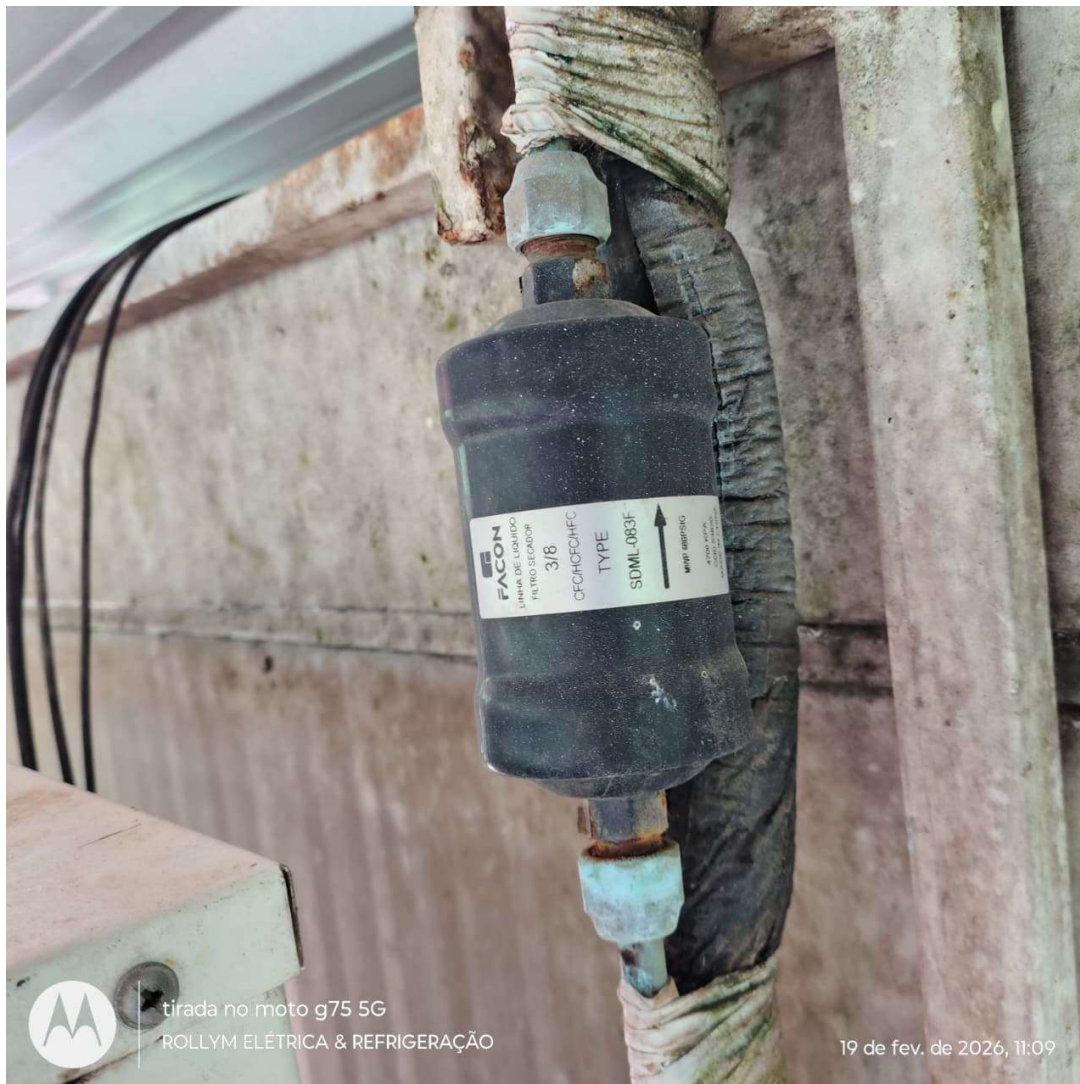
Foto 5 – Filtro secador do sistema de refrigeração. (equipamento 01)
