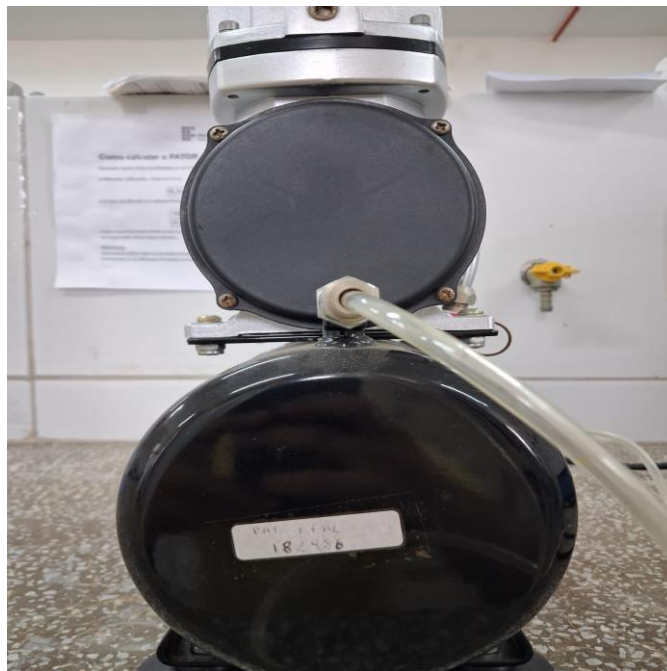
Figura 63 – Vista posterior compressor 01.
