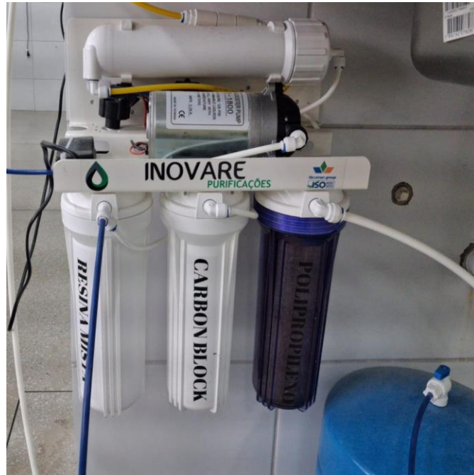
Figura 18 – Vista filtros deionizador 01.
