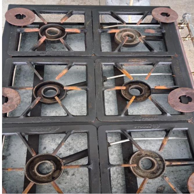
Figura 52 – Vista superior fogão 01.
