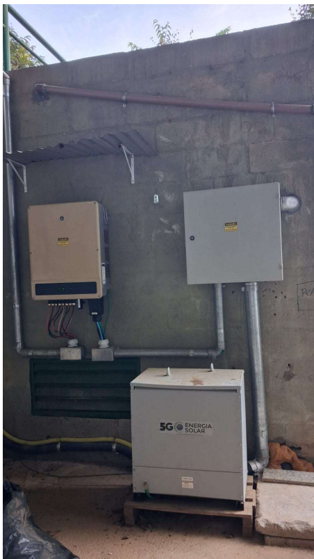
Inversor e DPSs do Sistema de geração fotovoltaico do Ginásio.
