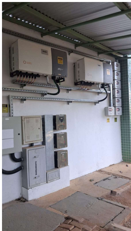
Inversores e DPSs do Sistema de geração fotovoltaico do Bloco II.
