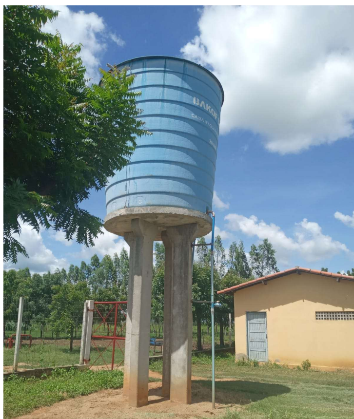
Figura 6. Caixa d'água 4, capacidade 20.000 L, 7,0 metros de altura, sem acesso por escadas, próximo ao Galpão Experimental. IFRN, 2024.
