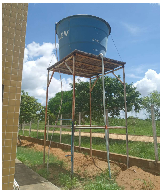
Figura 4. Caixa d'água 2, capacidade 5.000 L, 5,4 metros de altura, sem acesso por escadas, Setor da Piscina. IFRN, 2024.
