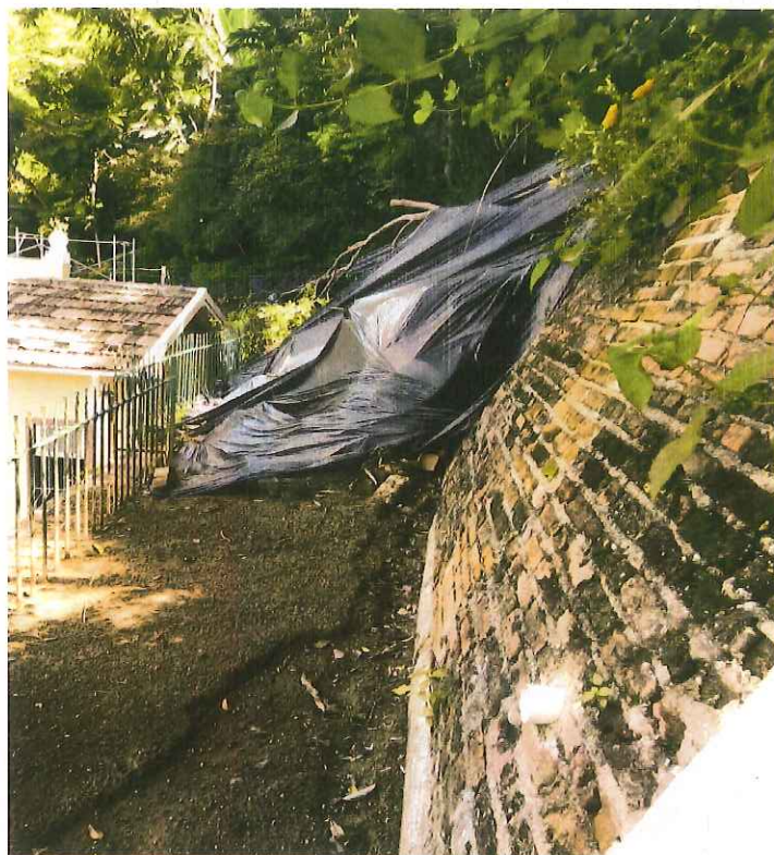
Foto 1 – Vista lateral de parte do muro que rompeu e não chegou a atingir a casa do museu
