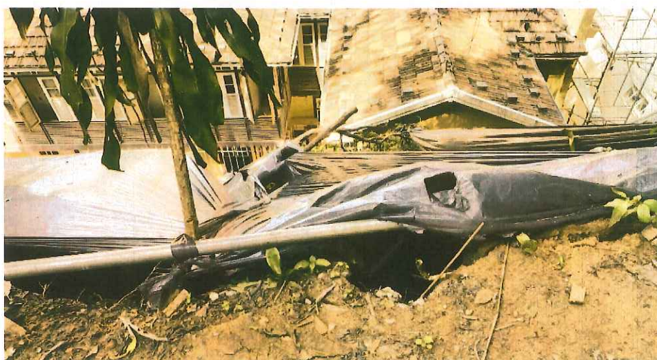
Foto 2 – Vista da parte superior mostrando a casa do museu que corre risco de atigimento.
