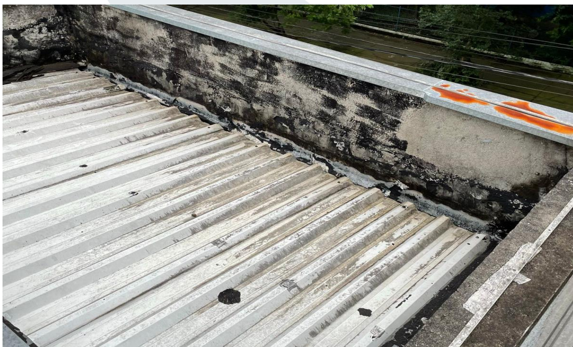
Foto 03 – Situação atual das pingadeiras.
