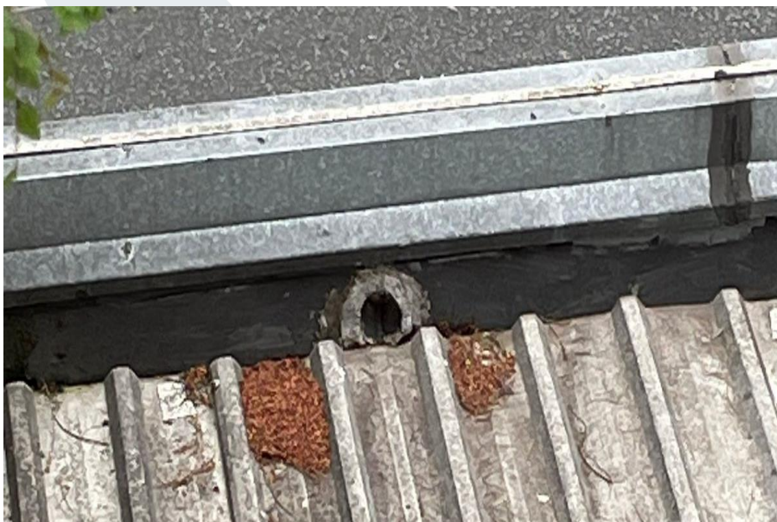
Foto 04 – Tubo lateral acima da altura da calha de concreto.
