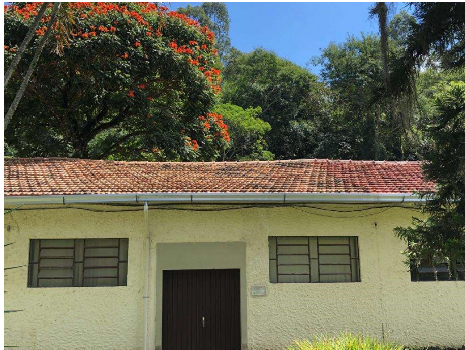
Figura 5 - Deformação do telhado vista de fachada
