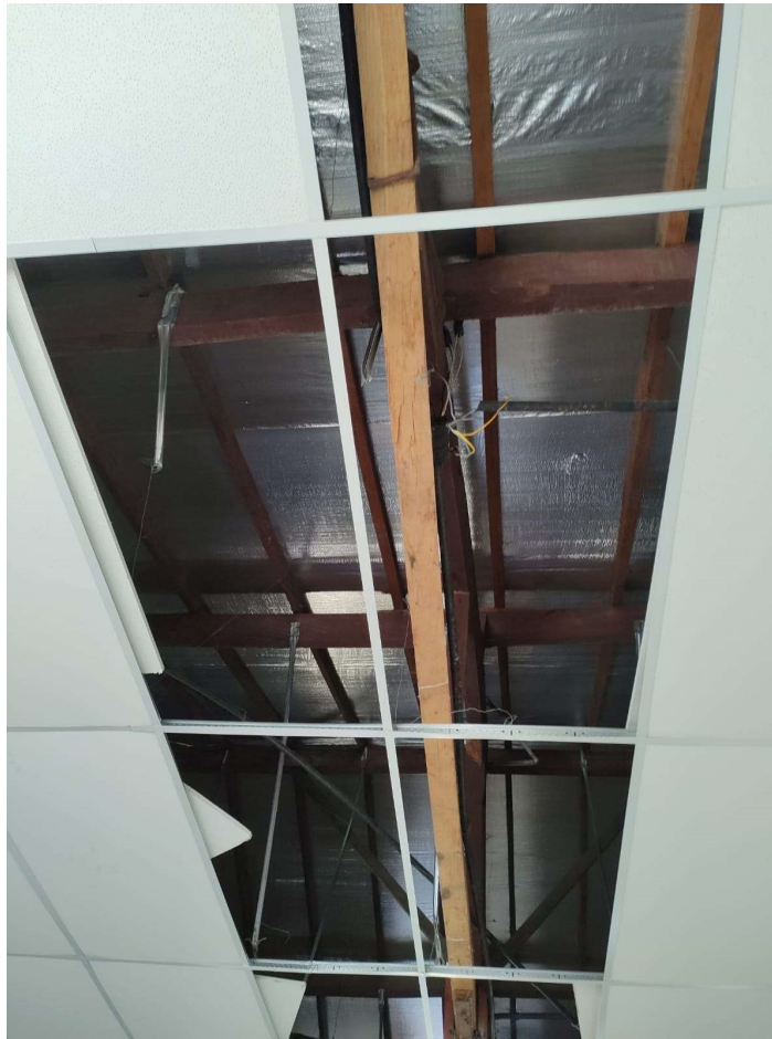
Figura 3 - Elementos estruturais desalinhados
