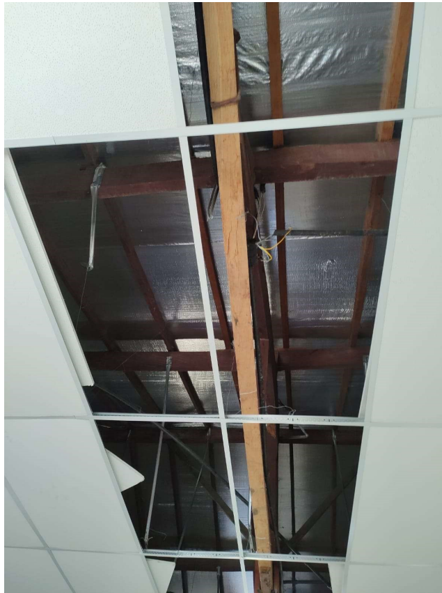
Figura 1 - Banzo inferior sem tratamento adequado
