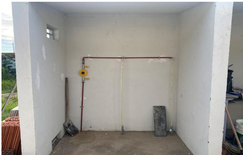
Figura 23 – Detalhe Instalações de Gás Combustível.
