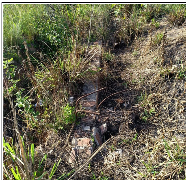
Foto 04: fundações sem impermeabilização
