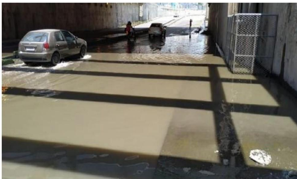
Figura 4 – Alagamento no túnel mesmo sem chuva
