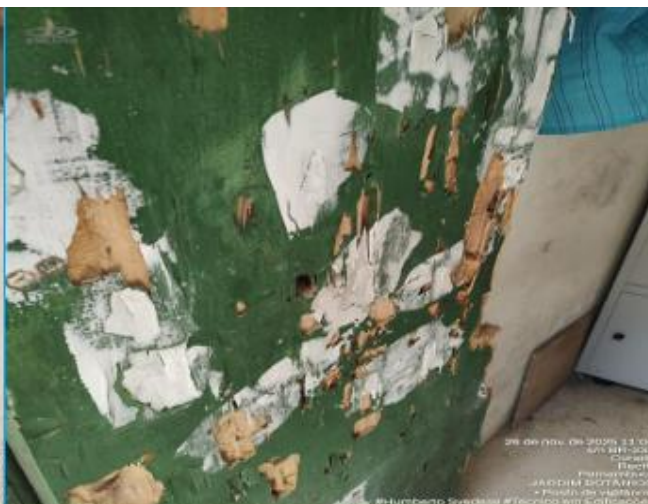
Foto 02: Porta danificada por cupins.
