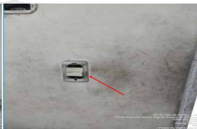
Foto 04: Interruptor sem capa.
