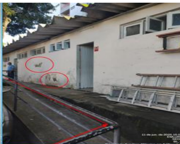
Foto 54: BL D, precisando de limpeza e pintura nas paredes e corrimão.
