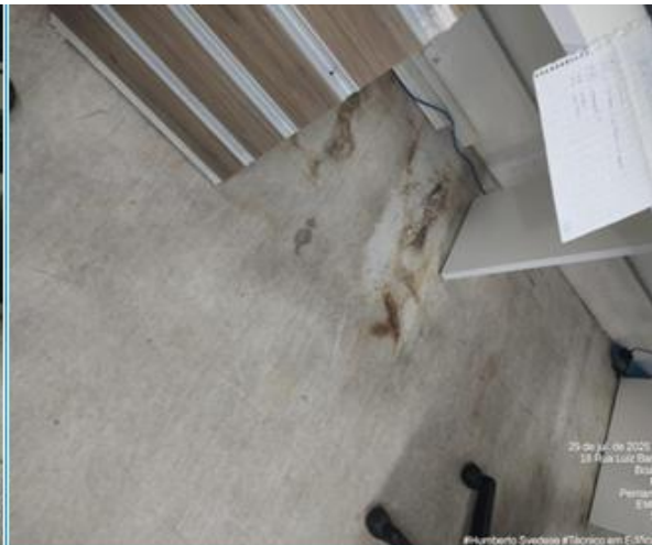
Foto 38: Piso em destacamento e desgaste com abrasão.
