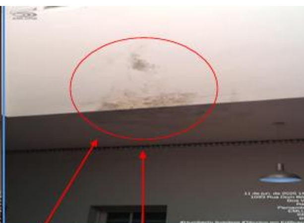
Foto 02: BL A, presença de mofo e bolor.
