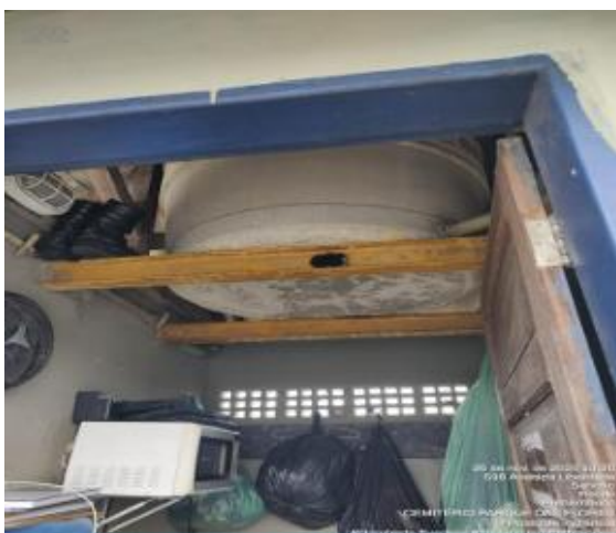
Foto 01: Posto de vigilância 02, reservatório transbordando devido a ausência de nível mecânico.
