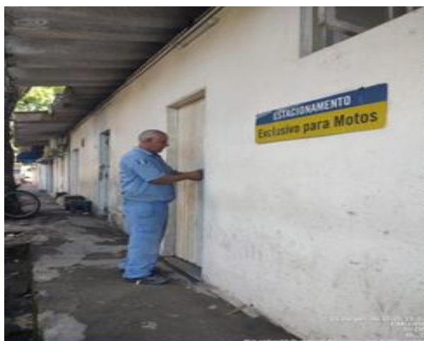
Foto 53: BL D, precisando de limpeza e pintura.
