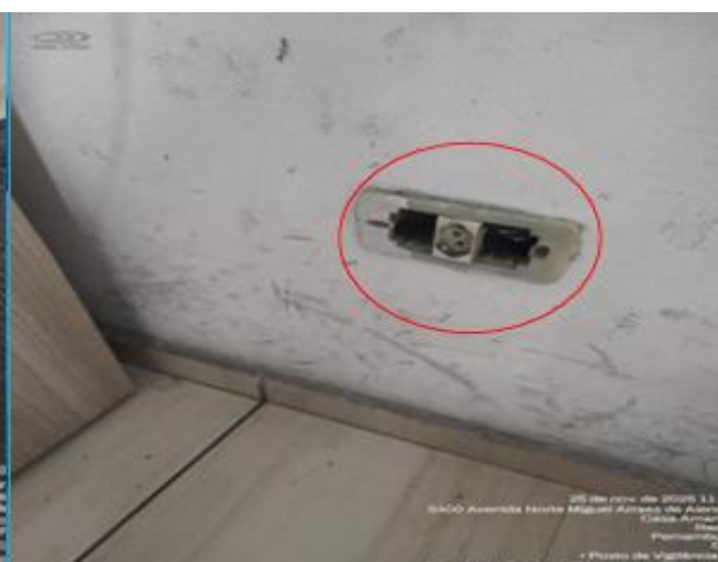
Foto 08: Interruptor sem capa.
