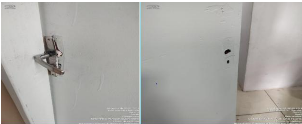
Foto 01: Posto de vigilância 01, fechadura quebrada.
