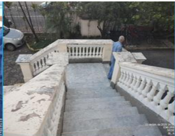
Foto 50: BL A, escadaria externa precisando de limpeza e pintura.
