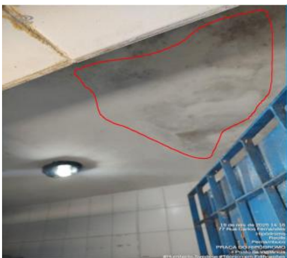
Foto 01: Sala de vigilante com teto desplacando.
