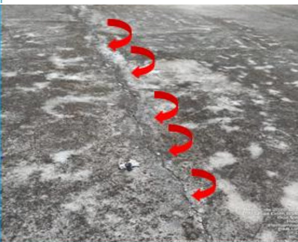
Foto 08: BL A, alpendre superior com fissuras e sem proteção impermeável.
