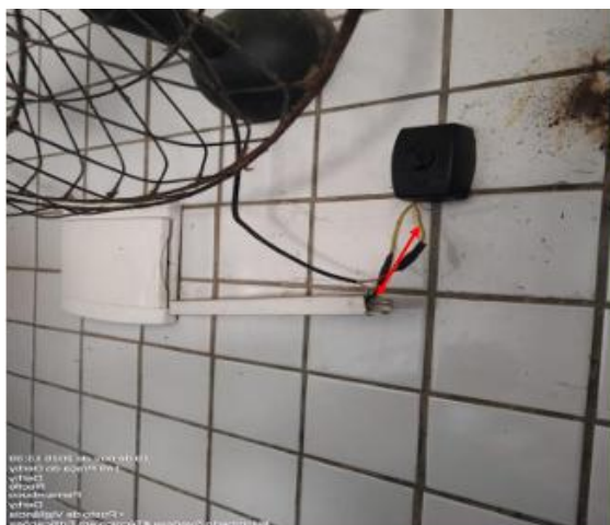
Foto 03: Cabos de energiação do ventilador com canaleta solta.
