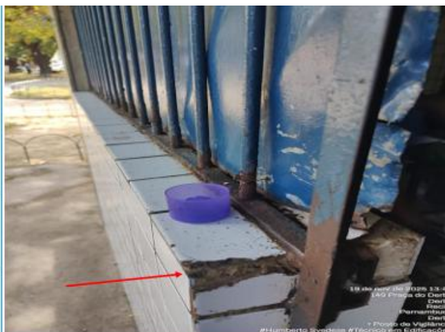
Foto 04: Cerâmica quebrada na entrada do posto.
