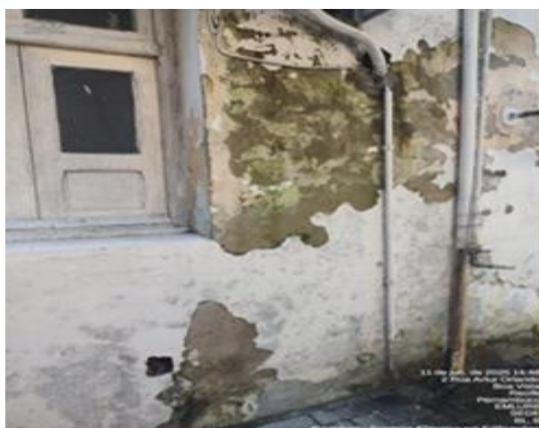
Foto 61: BL B, precisando de limpeza e pintura nas paredes.
