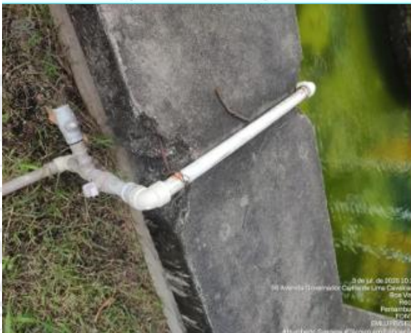
Foto 05: Mureta perimetral com corrosão
