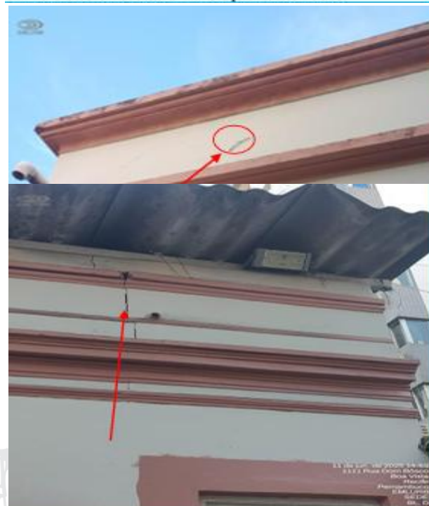
Foto 15: BL D, rachadura na platibanda.
