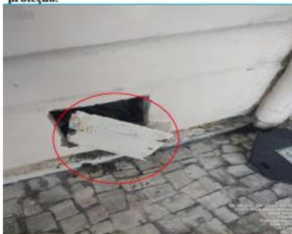
Foto 29: BL A, ponto de energia com tampa danificada.
