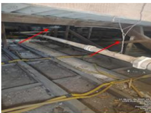
Foto 35: BL A, com amarração inadequada, podendo se soltar com determinado tempo devido à corrosão do arame recozido 18.
