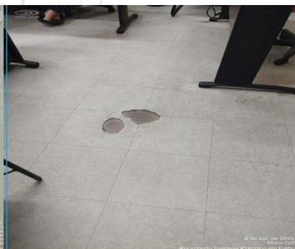
Foto 46: Piso em destacamento e desgaste com abrasão.
