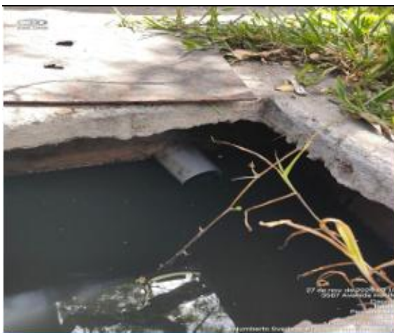
Foto 07: Sistema séptico dando retorno e transbordando.
