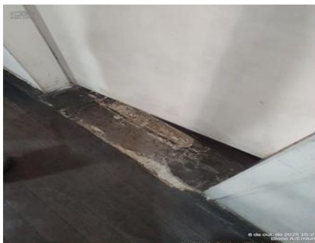
Foto 27: Piso sem soleira em tacos (Sala da DAF)
