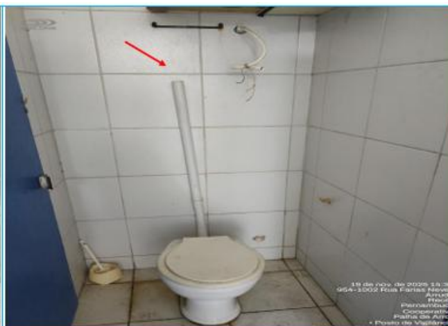
Foto 04: WC masculino sem descarga suspensa.
