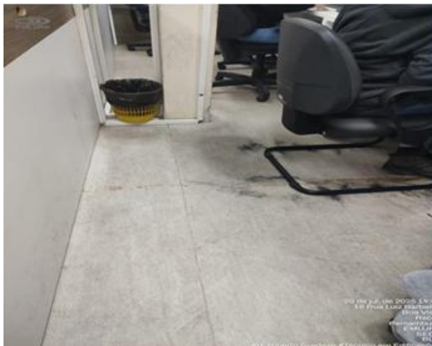
Foto 39: Piso em destacamento e desgaste com abrasão.
