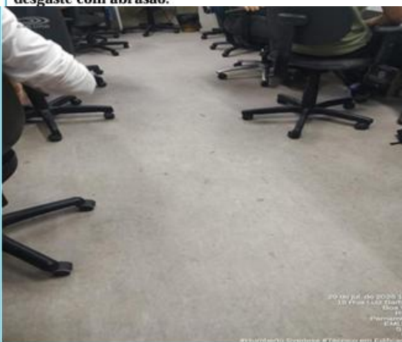
Foto 36: Piso em destacamento e desgaste com abrasão.
