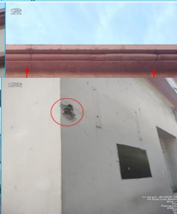
Foto 16: BL B, elemento de mangueira do ar-condicionado foi retirado e não realização o fechamento da passagem do duto.
