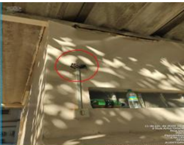
Foto 34: Anexo Auditório, ponto de energia sem tampa de proteção.
