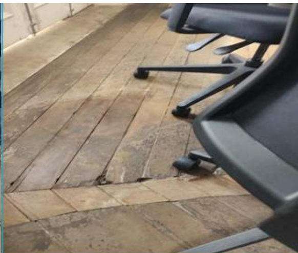
Foto 26: Piso de tacos com reentrâncias e buracos.
