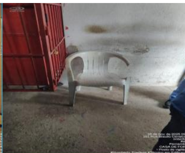
Foto 04: Paredes interna precisando de pintura.
