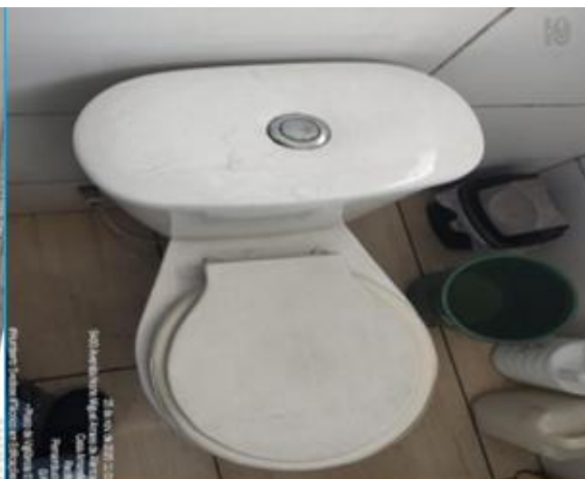
Foto 06: Mecanismo de descarga acoplada quebrado.
