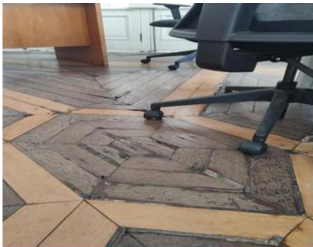
Foto 25: Piso de tacos com reentrâncias e buracos.
