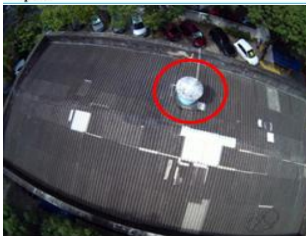
Foto 41: BL B, reservatório superior precisando de limpeza.
