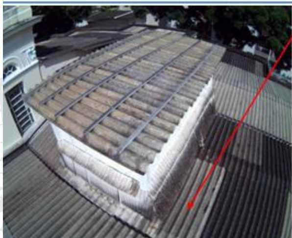
Foto 03: BL A, raiz da causa da infiltração.
