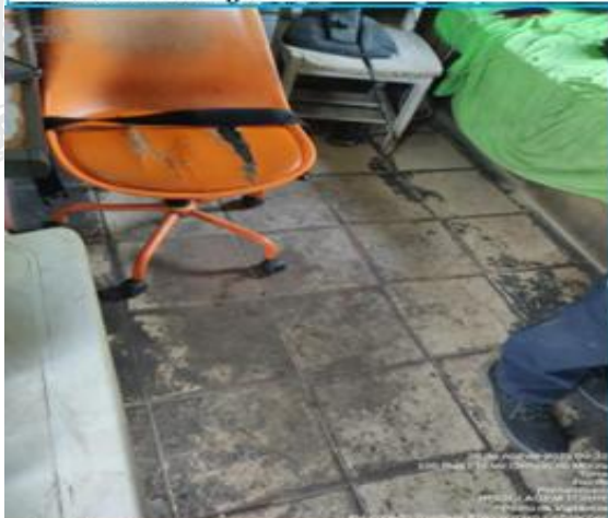
Foto 03: Piso cerâmico com corrosão.
