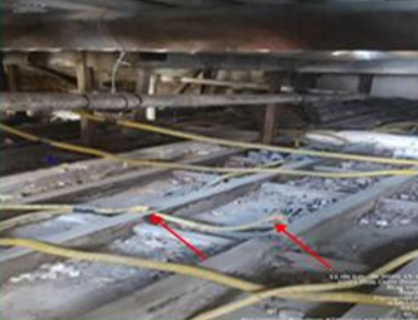
Foto 26: BL A, instalação elétrica com cabos e dutos em estado de deterioração.
