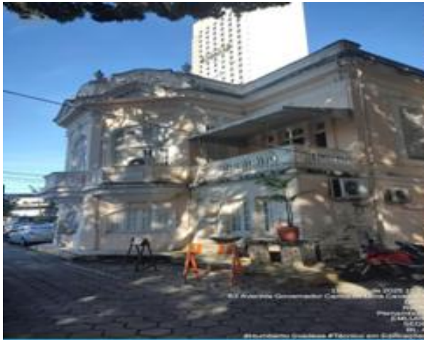
Foto 45: BL A, precisando de limpeza e pintura.
