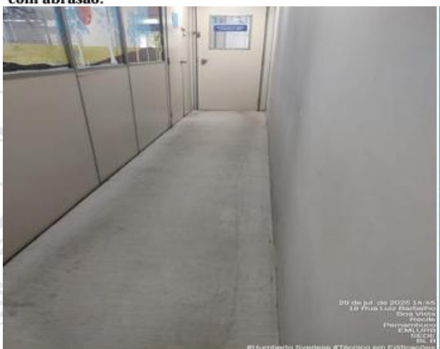
Foto 35: Piso em destacamento e desgaste com abrasão.
