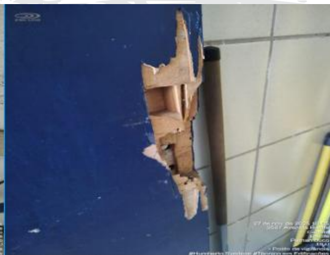
Foto 06: Porta danificada e sem fechadura.
