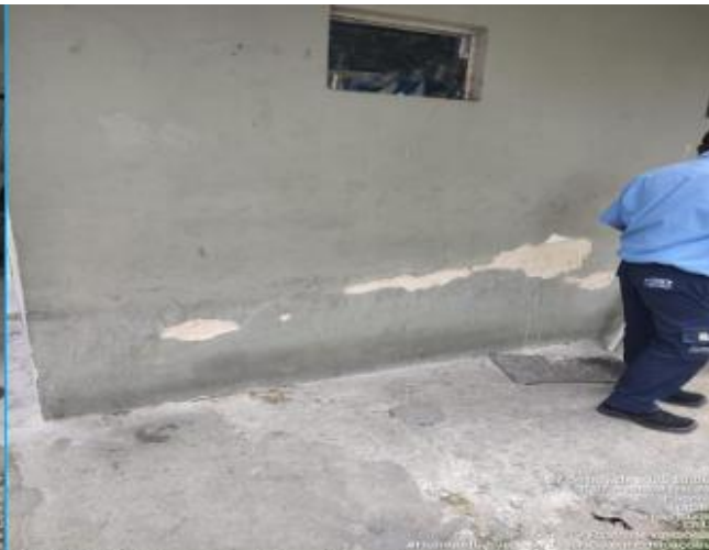
Foto 02: Pintura com desgaste e reboco soltando.
