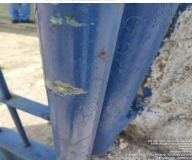
Foto 01: Portão com empeno devido a colisão com caminhão.
