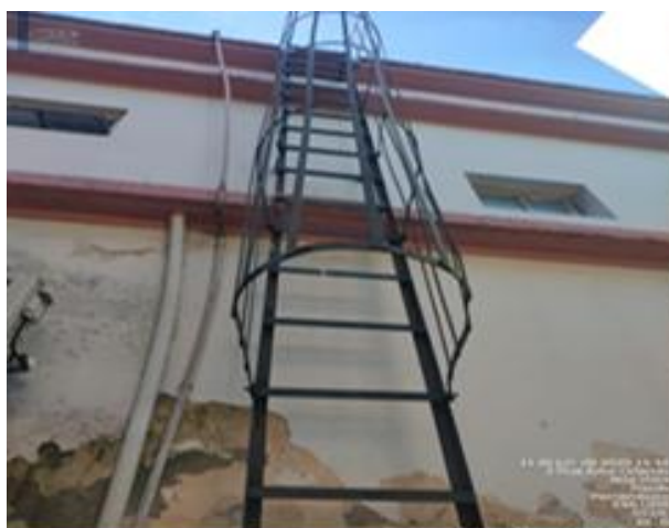
Foto 55: BL B, precisando de limpeza e pintura nas paredes e escada em aço de acesso a cobertura.
