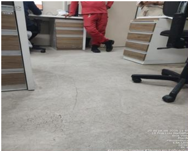
Foto 37: Piso em destacamento e desgaste com abrasão.
