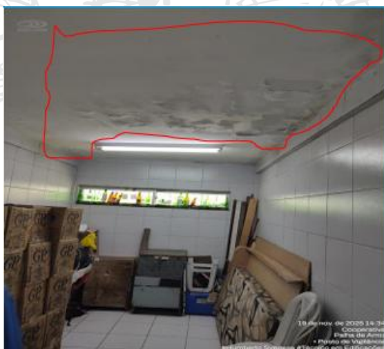
Foto 01: Sala de vigilante com teto descolando.
