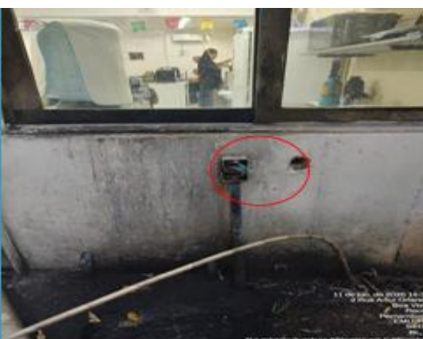
Foto 32: BL C por trás do DRH, ponto de energia sem tampa de proteção.
