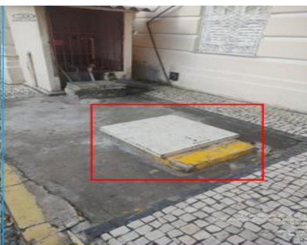
Foto 40: BL A, reservatório inferior precisando de limpeza.
