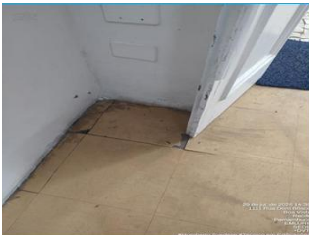
Foto 33: Bloco A entrada, piso em destacamento e desgaste com abrasão.
