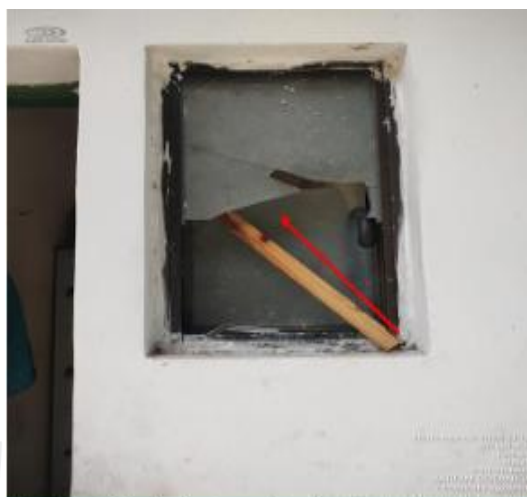
Foto 03: Vidro de janela quebrado.
