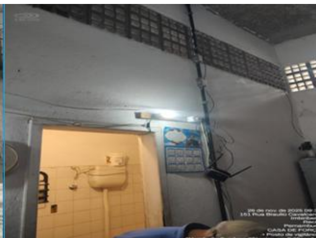
Foto 02: Cabos elétrico sem proteção.
