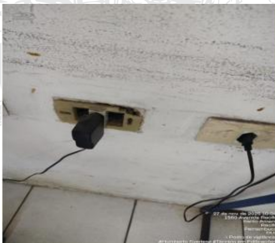
Foto 05: Tomada sem proteção (capa).
