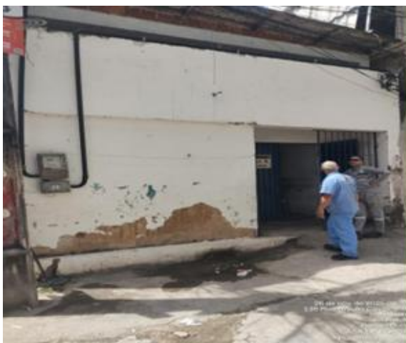
Foto 01: Fachada precisando de pintura e retoque no reboco.
