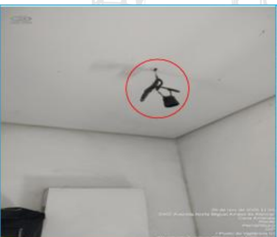
Foto 09: Ausência de lâmpada e suporte.
