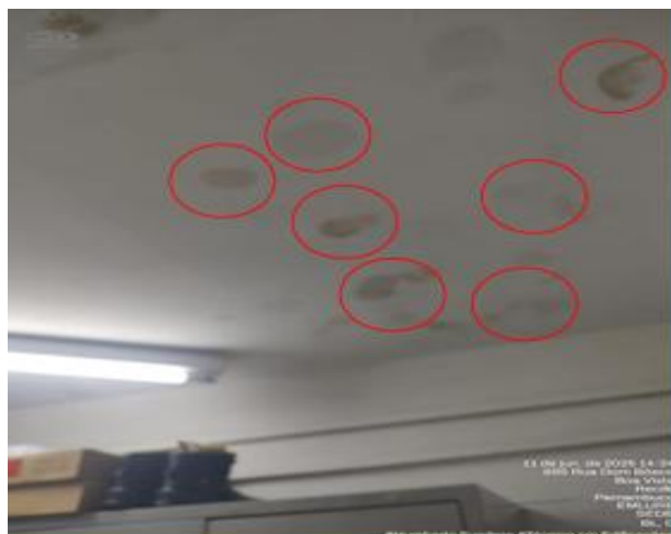
Foto 11: BL, C, Sala da Segurança do Trabalho, presença de mofo e bolor devido à infiltração nos telhados.
