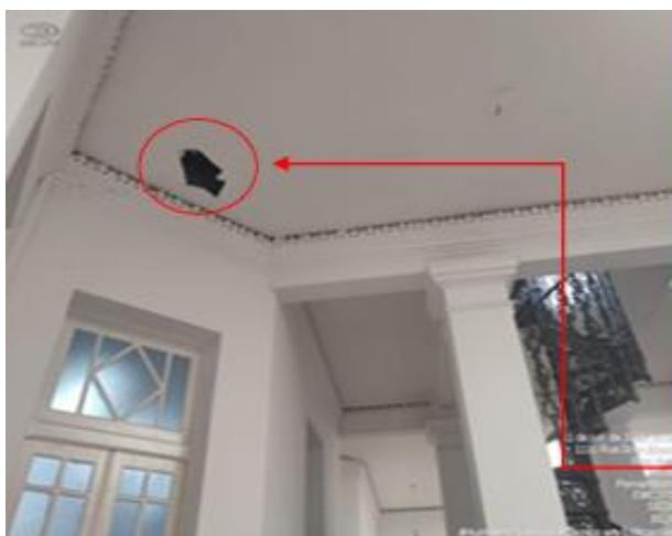
Foto 05: BL, A 1º Andar, deslocamento do revestimento do teto (gesso), devido a uma colisão, área interna.
