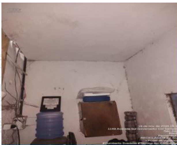
Foto 03: Recinto empoeirado e com manchas nas paredes.
