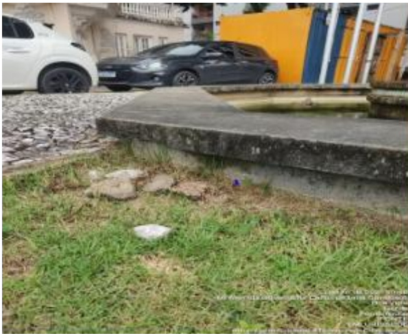
Foto 03: Mureta perimetral sem impermeabilizante
