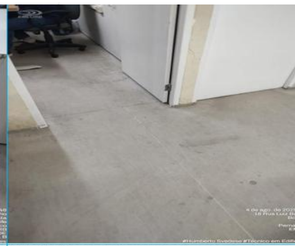
Foto 42: Piso em destacamento e desgaste com abrasão.
