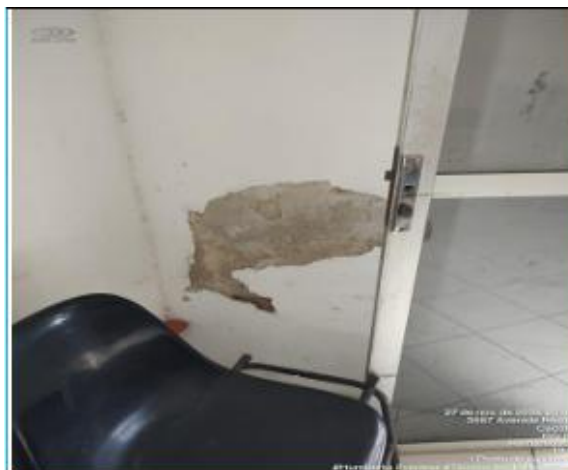
Foto 03: Parte interna com reboco caindo.
