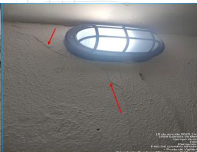
Foto 02: Fissuras com reboco, preste a cair.
