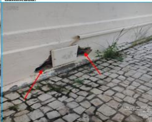
Foto 30: BL A, ponto de energia com abertura na periferia da caixa de proteção.
