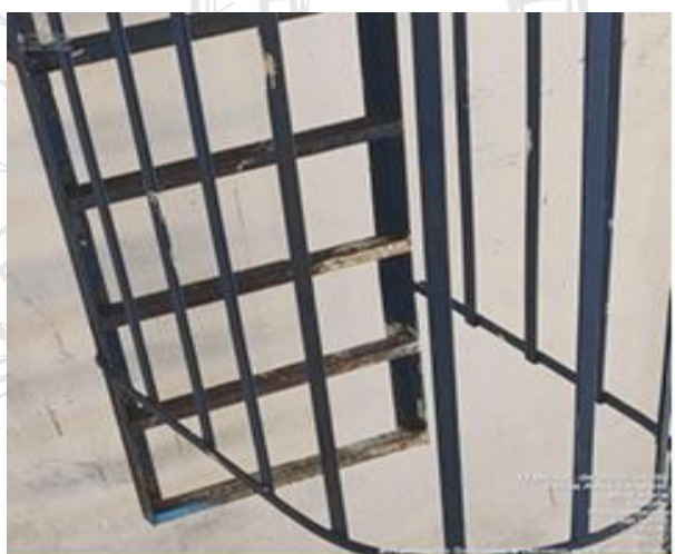
Foto 57: BL C, precisando pintura na escada de aço com acesso a cobertura.
