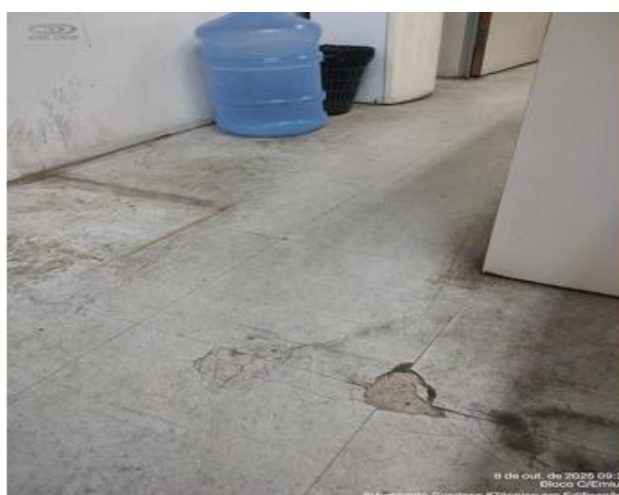
Foto 43: Piso em destacamento e desgaste com abrasão.
