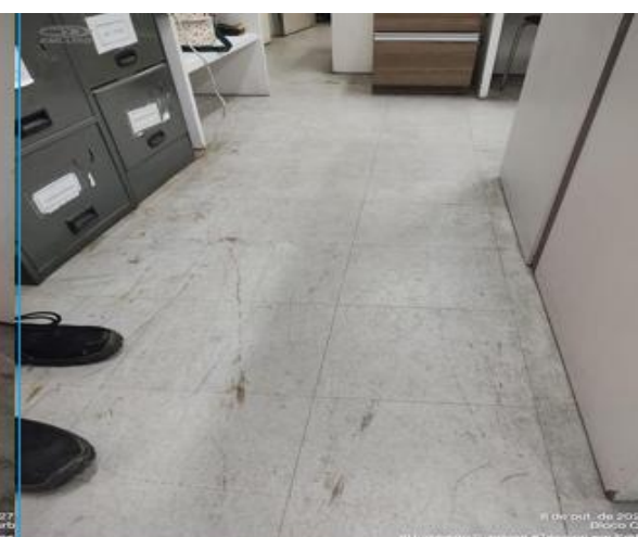
Foto 44: Piso em destacamento e desgaste com abrasão.
