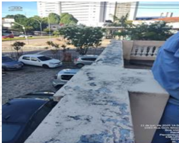
Foto 49: BL A, escadaria externa precisando de limpeza e pintura.
