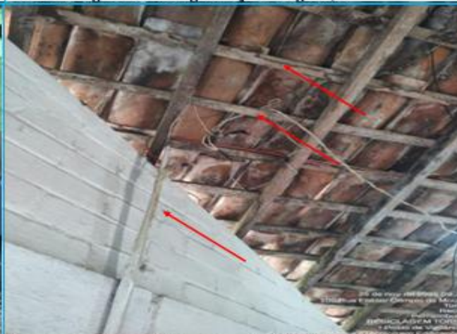
Foto 04: Instalações elétricas irregulares; barrotes e ripas deteriorados.
