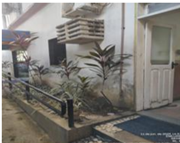
Foto 59: BL B, Necrópoles, precisando de limpeza e pintura nas paredes e corrimão.
