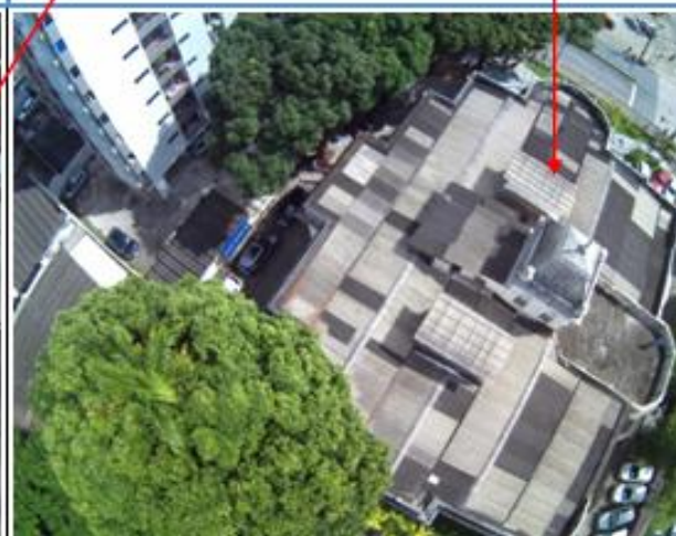
Foto 04: BL A, localização espacial do problema de infiltração da cobertura BL, A.
