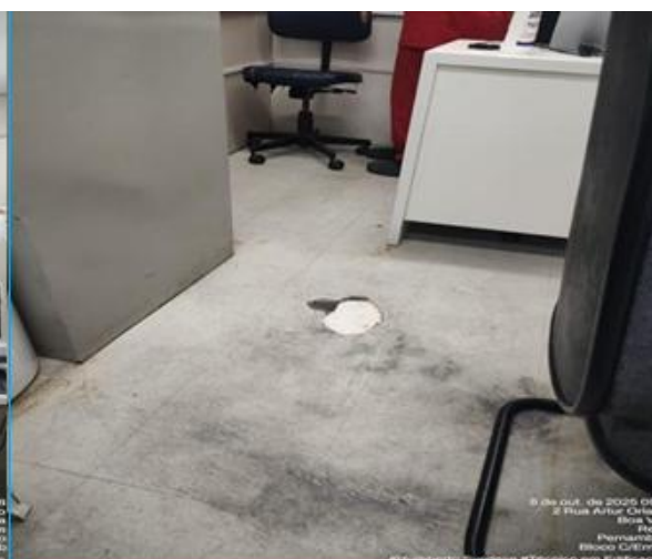
Foto 44: Piso em destacamento e desgaste com abrasão.
