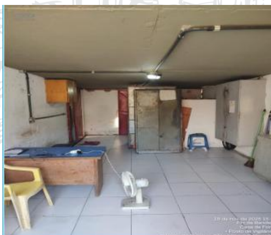
Foto 03: Cabos de energização do ventilador com canaleta solta.
