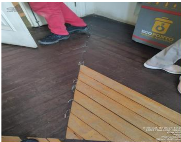
Foto 31: Piso com destacamento e reentrâncias.
