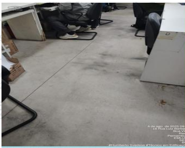
Foto 41: Piso em destacamento e desgaste com abrasão.
