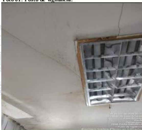
Foto 03: Forro de gesso rachado devido à infiltração.
