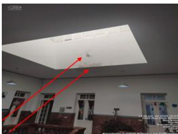
Foto 01: BL A, danos na estrutura da cobertura, como rachaduras e telhas com perfuração.
