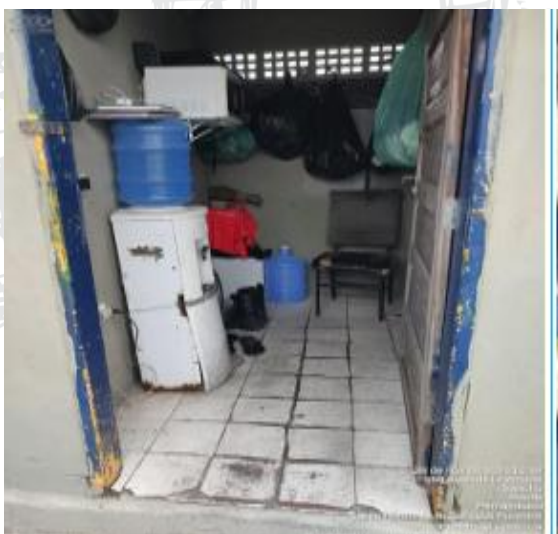
Foto 03: Revestimento cerâmico no piso quebrado.
