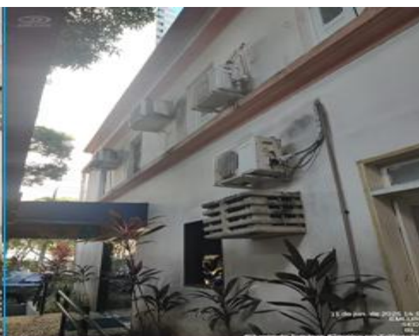
Foto 62: BL B, Necrópoles, precisando de limpeza e pintura nas paredes e corrimão.
