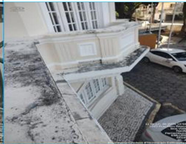
Foto 48: BL A, precisando de limpeza e pintura.
