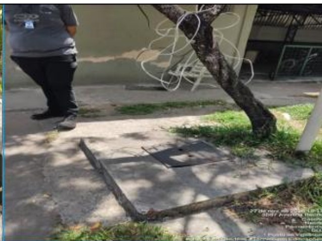
Foto 08: Fossa séptica sem sumidouro.
