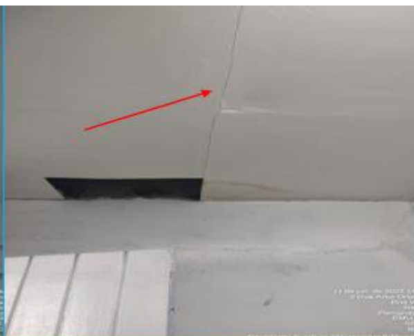
Foto 12: BL, C, Sala da Segurança do Trabalho, fissura no forro de gesso.
