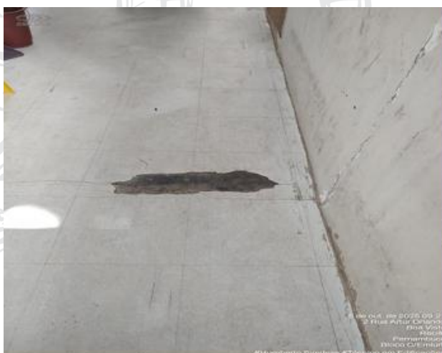
Foto 45: Piso em destacamento e desgaste com abrasão.
