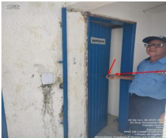
Foto 03: Porta com fechadura quebrada e manchas nas paredes.
