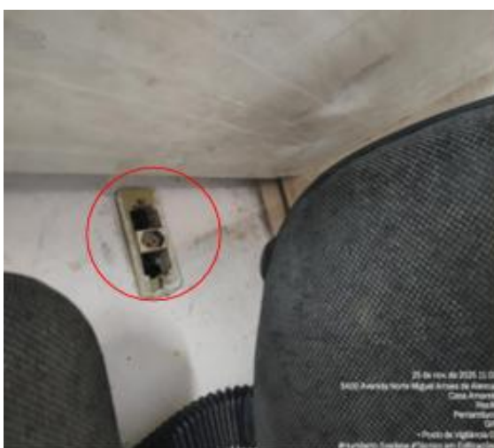
Foto 07: Interruptor sem capa.
