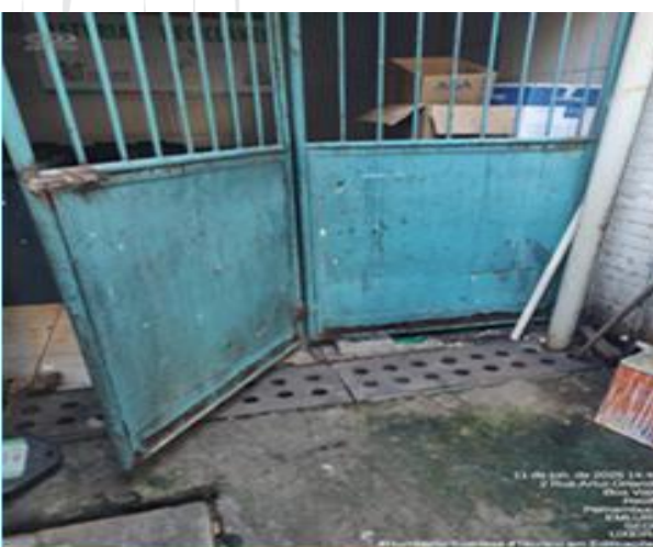
Foto 58: BL C, precisando pintura no portão da lixeira.
