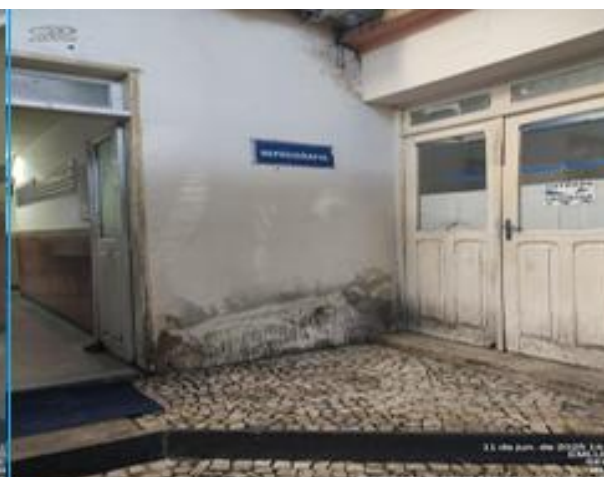
Foto 60: Acesso ao BL B, precisando de limpeza e pintura nas paredes.
