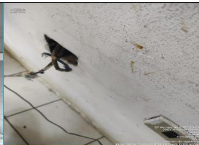
Foto 04: Gambiarra e ausência de tomada para instalação de equipamentos eletrônicos.
