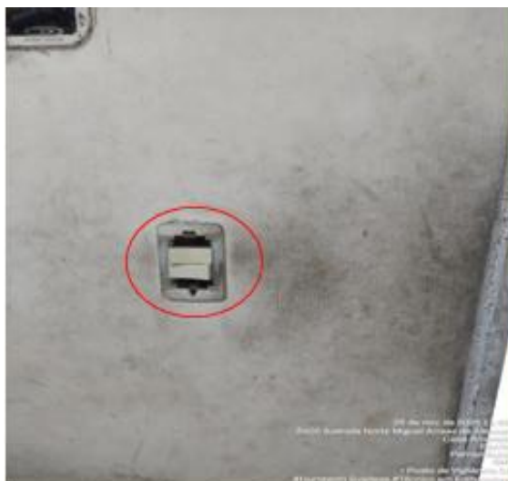
Foto 05: Interruptor sem capa.
