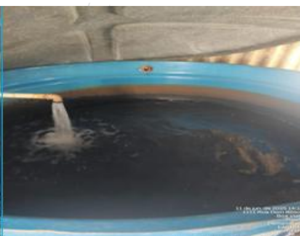
Foto 38: BL A, funcionamento do acionamento da bomba hidráulica em bom estado.
