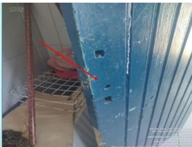
Foto 06: Porta sem fechadura.
