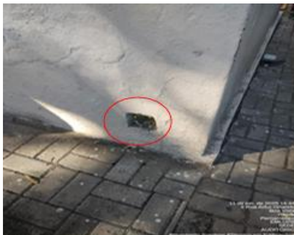
Foto 27: BL B, ponto de energia sem tampa de proteção.
