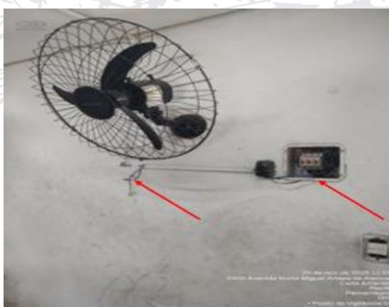
Foto 03: Ventilador sem funcionar.
