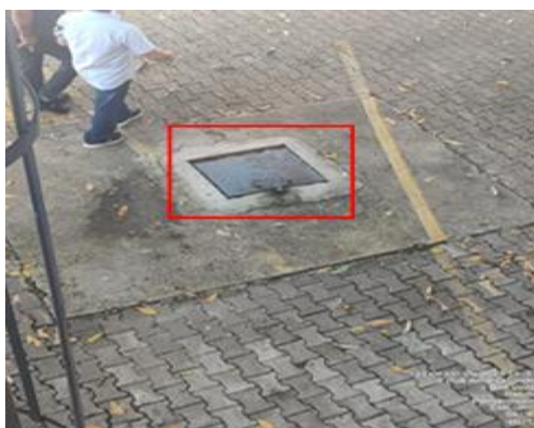
Foto 39: BL C, reservatório inferior precisando de limpeza.
