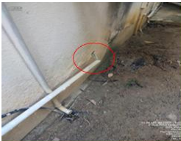
Foto 33: BL C por trás do DRH, eletrodutos com cabos expostos, sem fazer a função de proteção.
