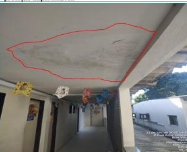
Foto 10: BL, C, 1º andar, presença de mofo e bolor devido à infiltração nos telhados.
