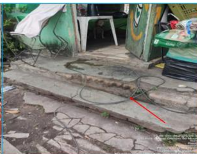
Foto 02: Degraus com desgastes (piso irregular).
