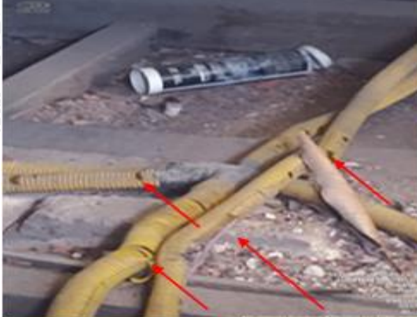
Foto 25: BL A, instalação elétrica com cabos e dutos em estado de deterioração.
