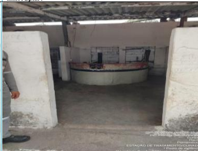
Foto 04: Posto de vigilância improvisado e sem estrutura.
