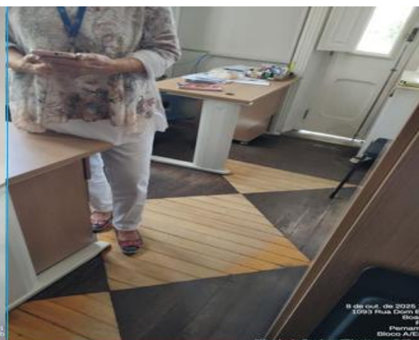
Foto 28: Piso opaco devido a abrasão com material de limpeza inadequado.
