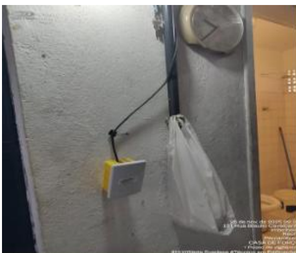
Foto 03: Caixa de tomada sem fixação correta.
