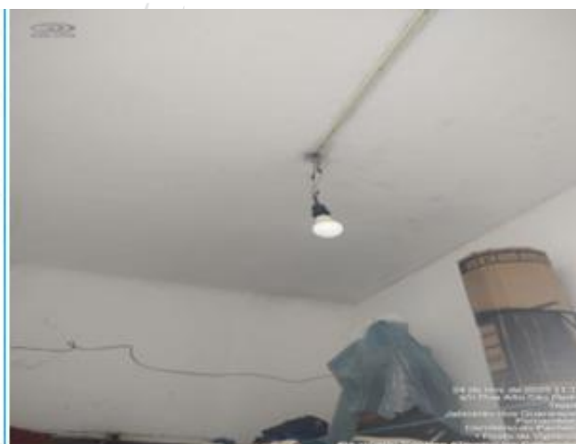
Foto 10: Sem suporte para lâmpada e sem capa da canaleta.
