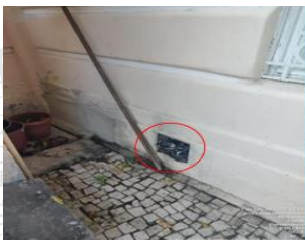
Foto 31: BL A, ponto de energia sem tampa de proteção.
