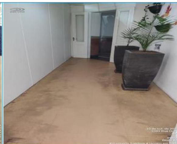
Foto 34: Bloco A entrada, piso em destacamento e desgaste com abrasão.
