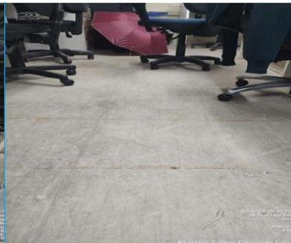
Foto 40: Piso em destacamento e desgaste com abrasão.
