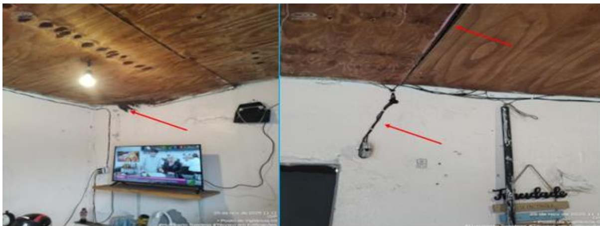
Foto 11: Teto com forro de madeira cedendo e instalação elétrica inadequada.
