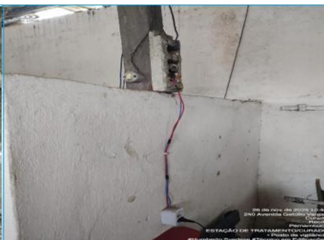
Foto 02: Ausência de elemento de proteção dos cabos, tomadas e interruptor.
