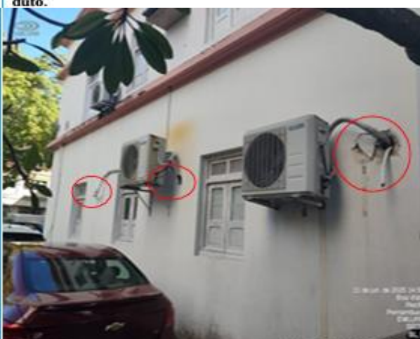
Foto 18: BL B, elemento de mangueira do ar-condicionado foi instalado sem fechamento da abertura de passagem do duto.
