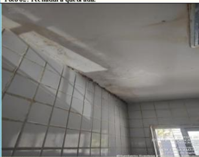
Foto 01: Presença de bolor no forro de gesso.
