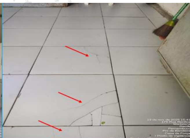
Foto 04: Cerâmica quebrada na entrada do posto.
