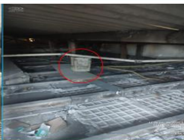
Foto 36: BL A, tubulação em PVC com conexões em metal. A tubulação estar apoiada sob um latão com tabua.
