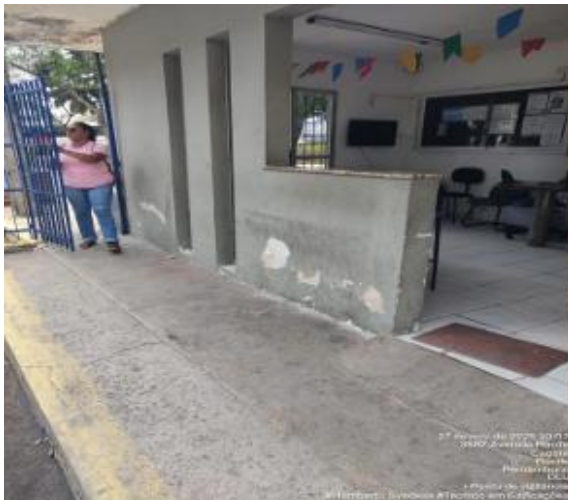
Foto 01: Posto de vigilância, reboco caindo.
