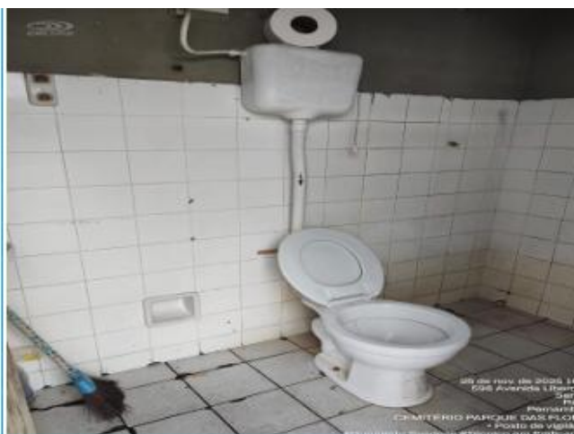
Foto 02: Ausência de elemento (espude) o que ocasiona vazamento pelo tubo de descarga.
