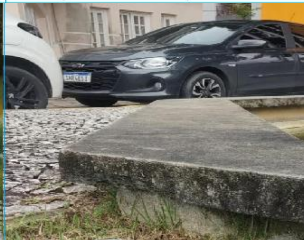
Foto 06: Mureta perimetral com corrosão
