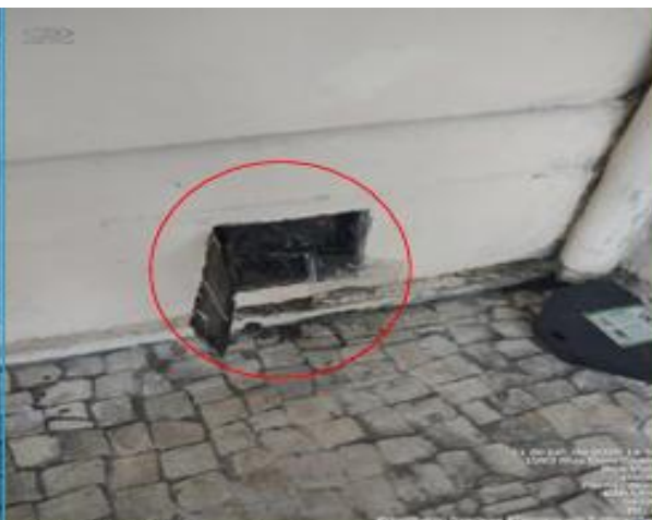
Foto 28: BL A, ponto de energia com tampa danificada.
