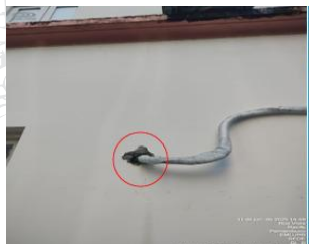
Foto 17: BL B, elemento de mangueira do ar-condicionado foi instalado sem fechamento da abertura de passagem do duto.
