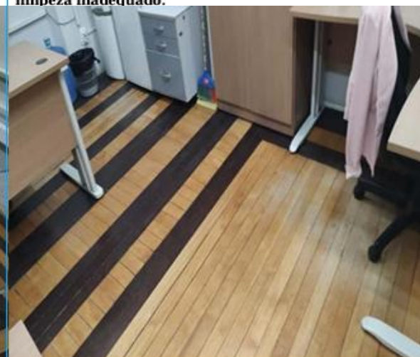
Foto 30: Piso precisando ser envernizado.
