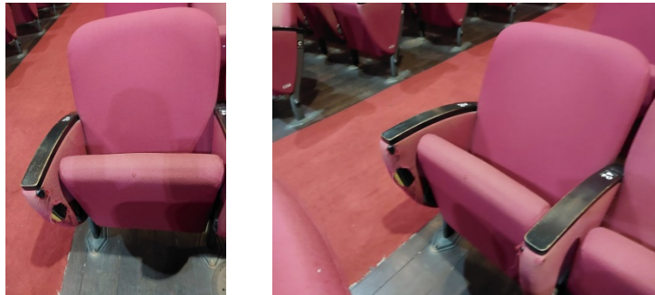
Imagem 10 e 11: Tapeçaria e poltronas da plateia desgastados, rasgados e desbotados.
