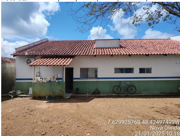
Foto 04: Fachada Posterior do prédio, realizar pintura.
