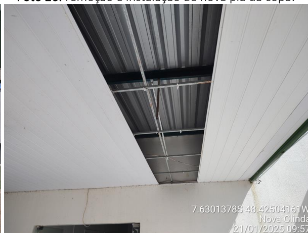
Foto 28: Forro de PVC a recuperar
