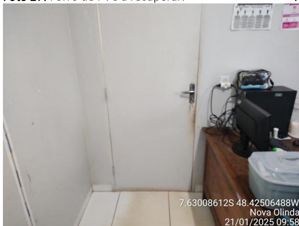
Foto 29: Portas e portais de madeira a substituir.
