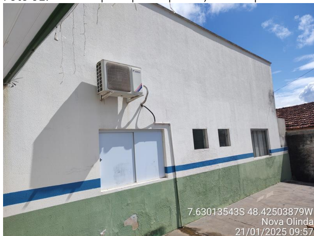
Foto 03: Fachada principal do prédio, realizar pintura.
