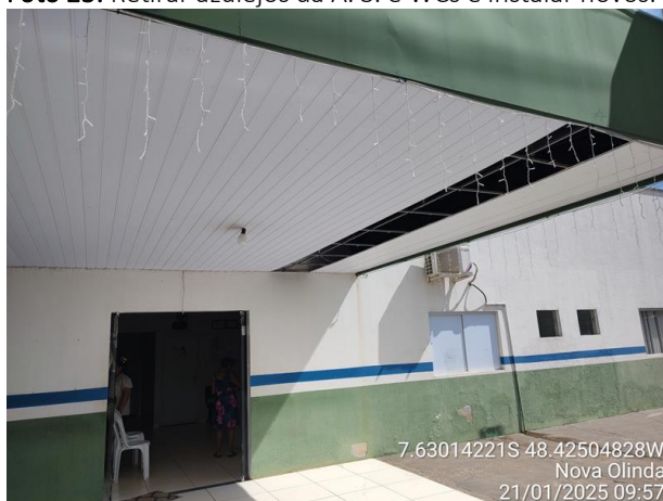
Foto 27: Forro de PVC a recuperar.
