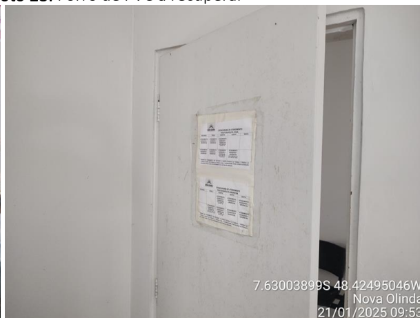
Foto 30: Portas e portais de madeira a substituir.
