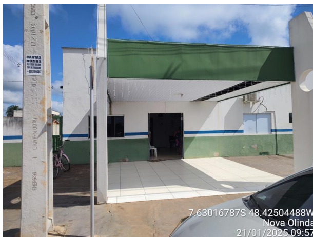
Foto 02: Fachada principal do prédio, realizar pintura.
