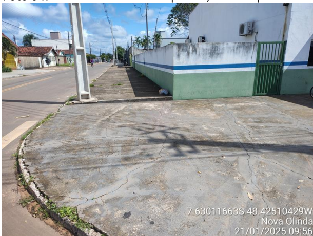
Foto 06: Muro Lateral, realizar pintura e elevar altura.
