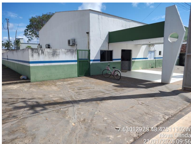
Foto 01: Fachada principal do prédio, realizar pintura.
