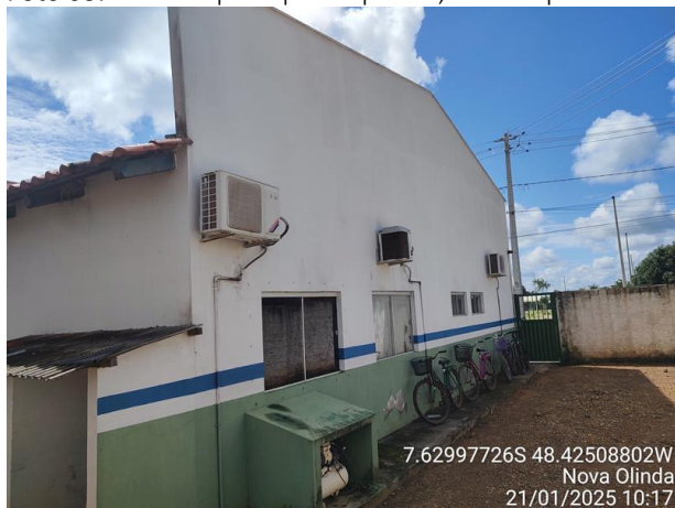
Foto 05: Fachada lateral do prédio, realizar pintura.
