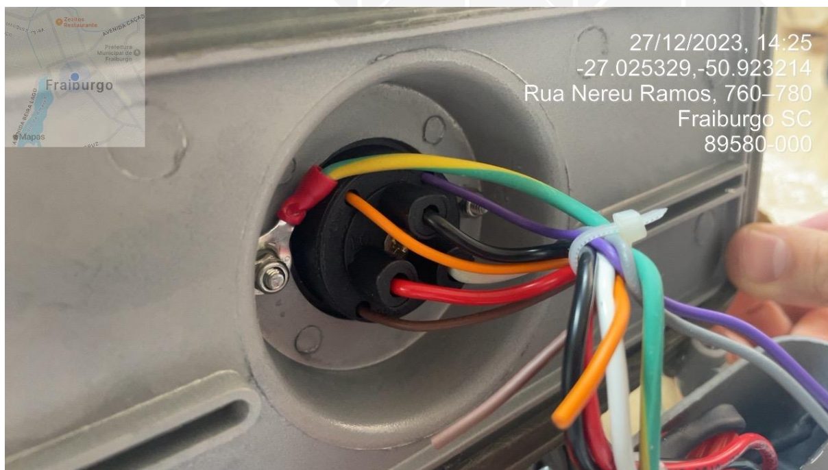
Figura 46 - Fixação da tomada de relé do item 10, com parafusos adequados
