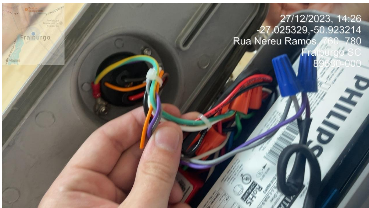
Figura 47 - Fiação interna do item 10
