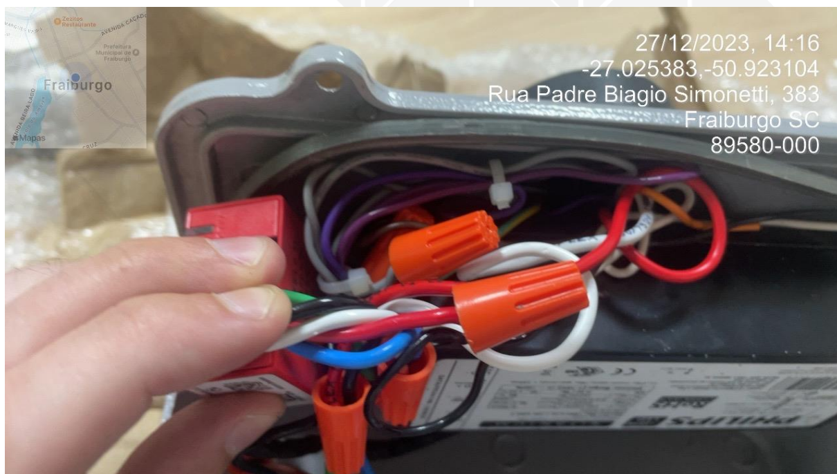
Figura 35 - Fiação interna do item 9
