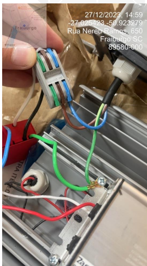
Figura 20 - Fiação interna do item 7
