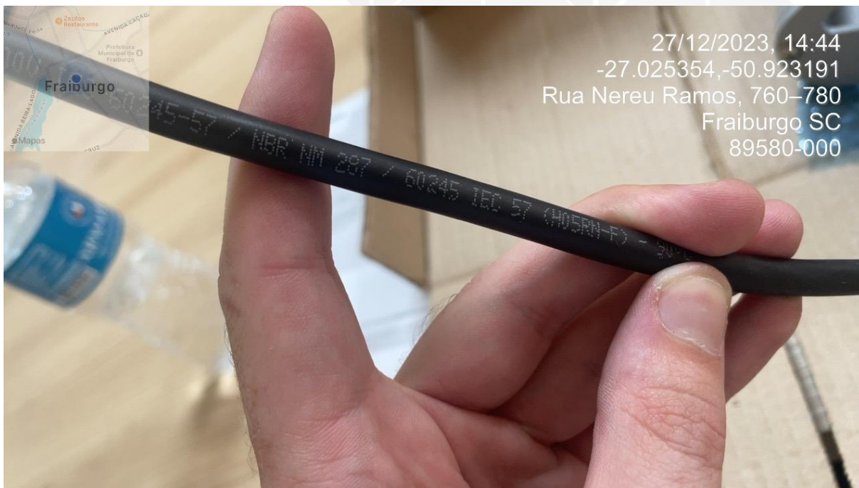
Figura 6 - Certificação do cabo externo do item 7
