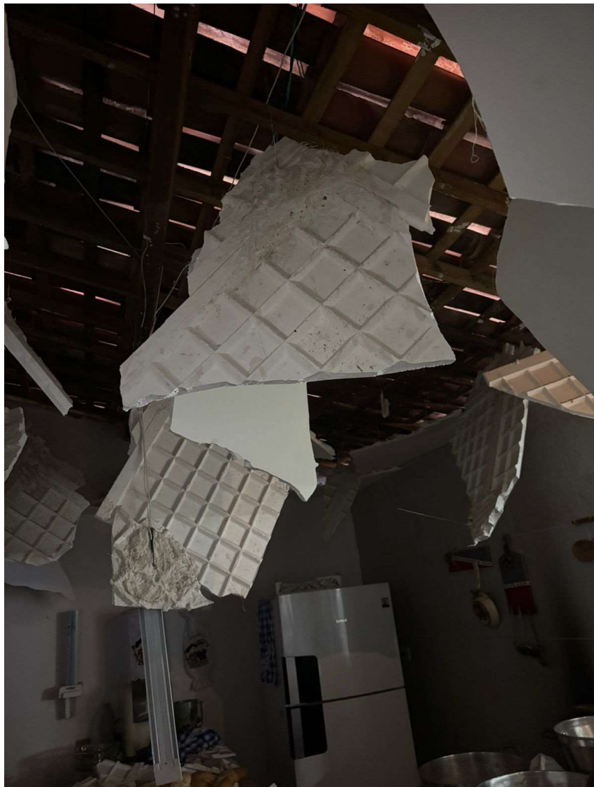
Fig. 04 – Forro de gesso danificado.
