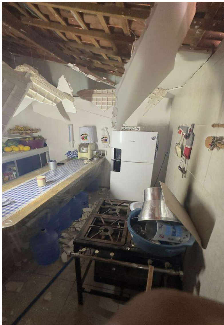
Fig. 05 – Forro de gesso danificado.
