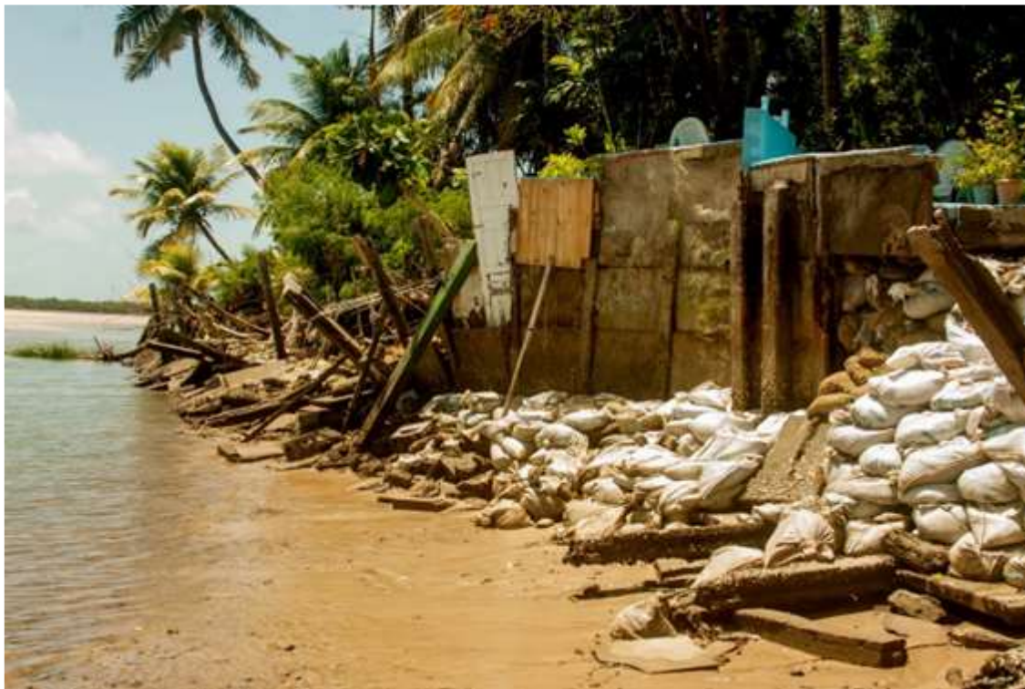
FIGURA 16: SOLUÇÃO ADOTA PELA COMUNIDADE PARA CONTER O DESASSOREAMENTO COM SACOS DE AREIA
