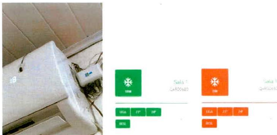
Foto 02: Momento após ligar o condicionador de ar via software.
