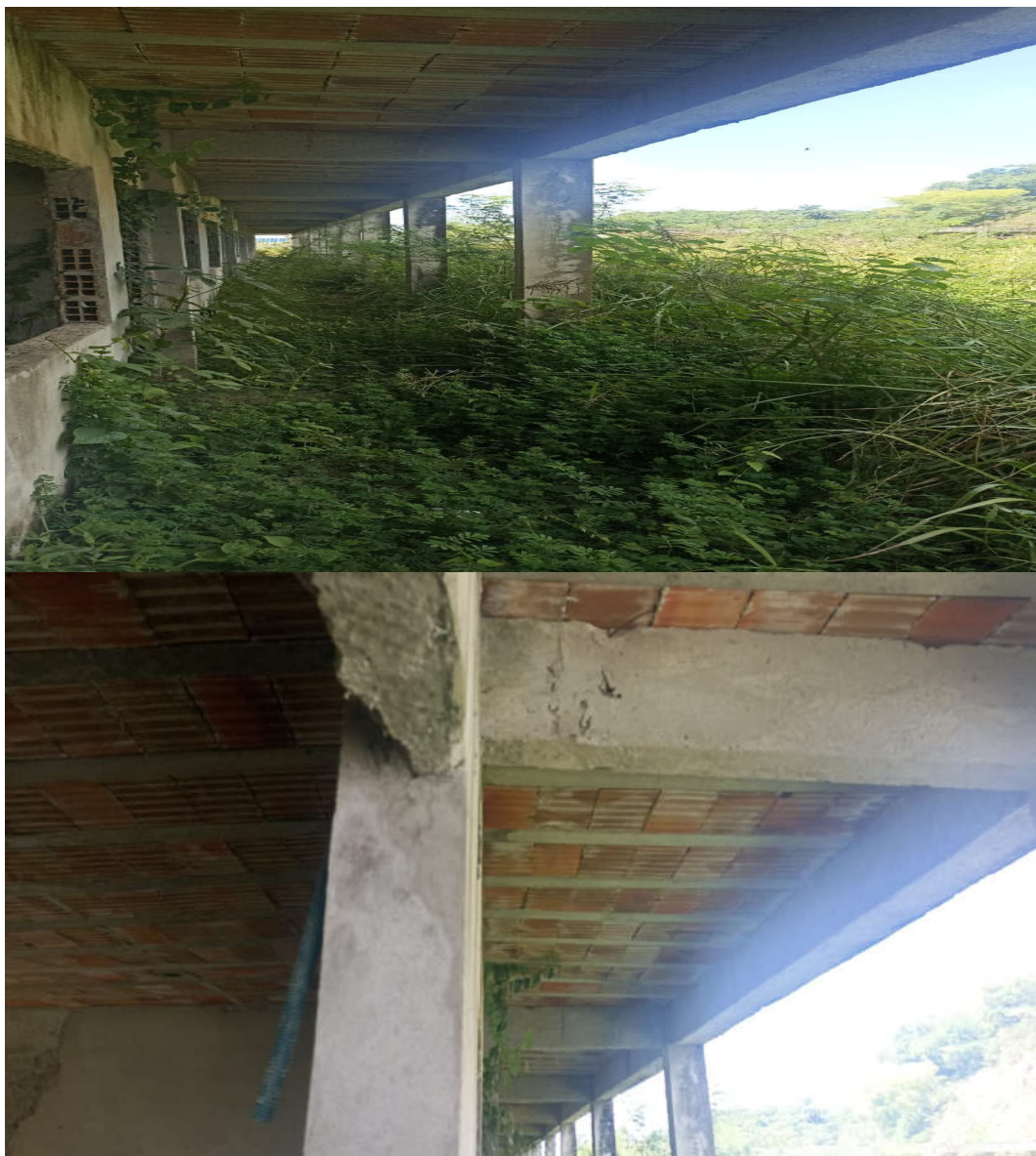
Foto 21 e 22: Vegetação em toda área da escola, vista da viga superior do corredor das salas.
