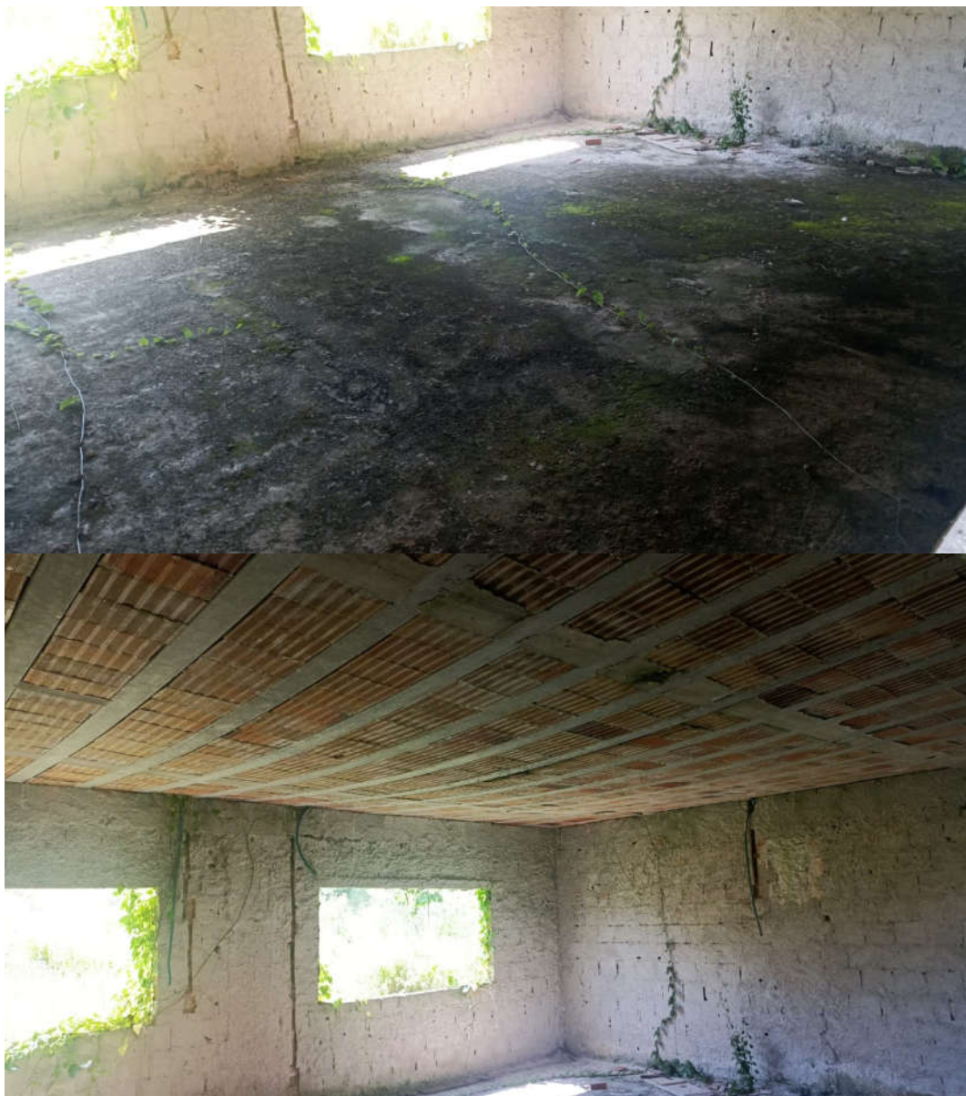
Foto 19 e 20: Laje da cobertura das salas apresentado recalque.
