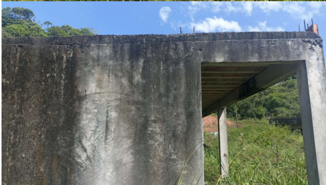
Foto 11 e 12: Edificação sem conclusão dos serviços, laje da cobertura das salas apresentado recalque.
