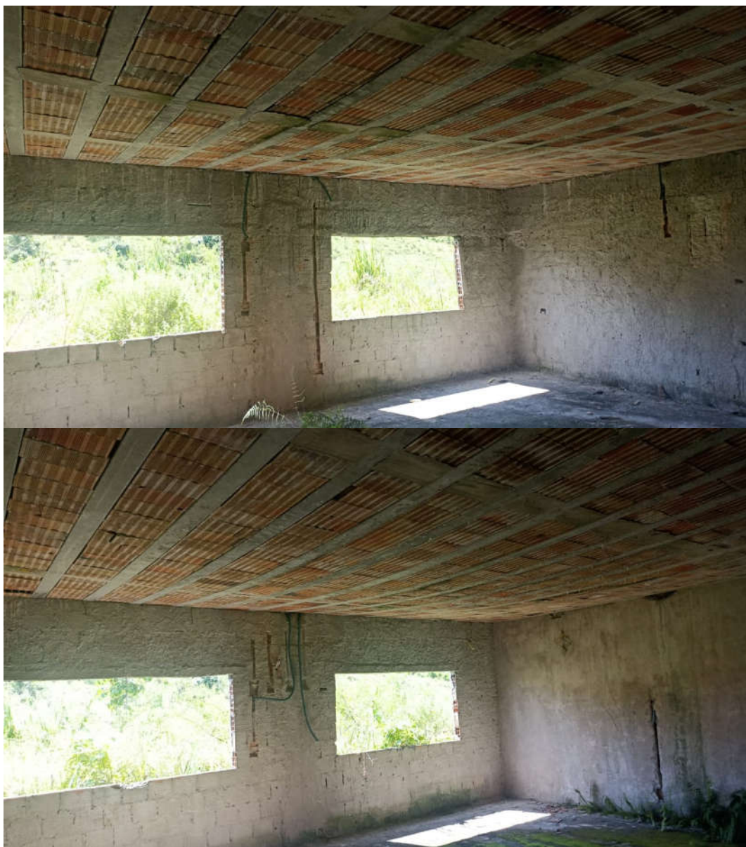
Foto 17 e 18: Laje da cobertura das salas apresentado recalque.
