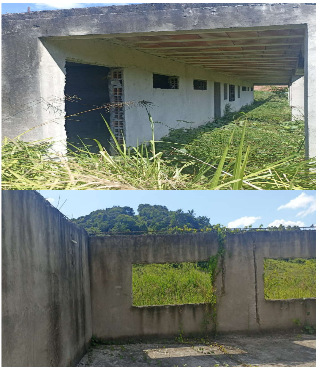
Foto 13 e 14: Edificação sem conclusão dos serviços, laje da cobertura das salas apresentado recalque.
