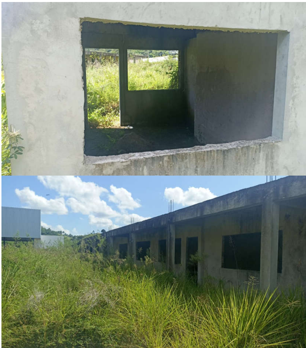
Foto 09 e 10: Edificação sem conclusão dos serviços, laje da cobertura das salas apresentado recalque.
