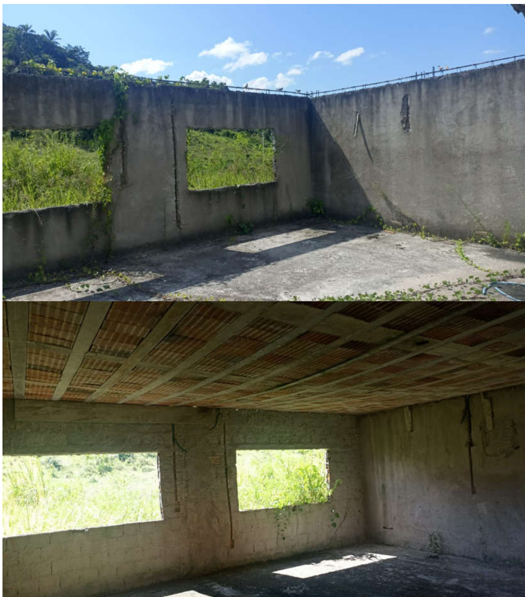
Foto 15 e 16: Edificação sem conclusão dos serviços, laje da cobertura das salas apresentado recalque.
