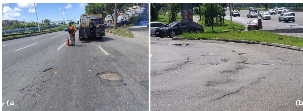
Figura 01 – Patologias no revestimento asfáltico em vias de Salvador. (a) Trincas interligadas e panela. (b) Escorregamento de capa.
