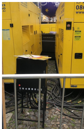
Foto 17: Posicionamento dos geradores
