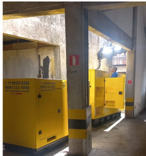
Foto 16: Posicionamento dos geradores
