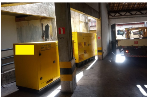
Foto 15: Posicionamento dos geradores
