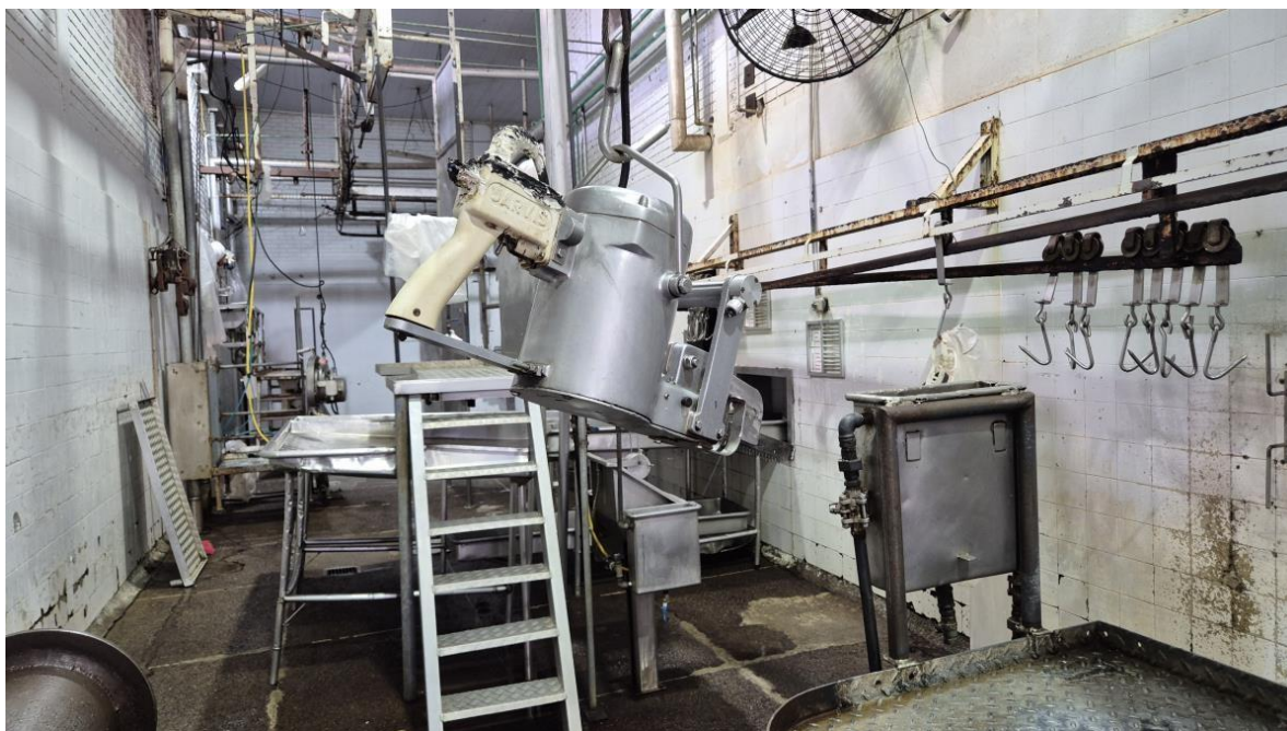
Foto 33: Sala de abate equipada (pias com esterilizadores, serras, mesas, etc.)
