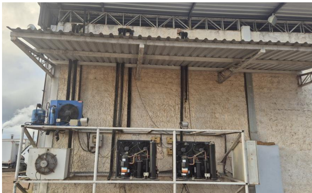
Foto 5: Sistema de frio de câmara fria
