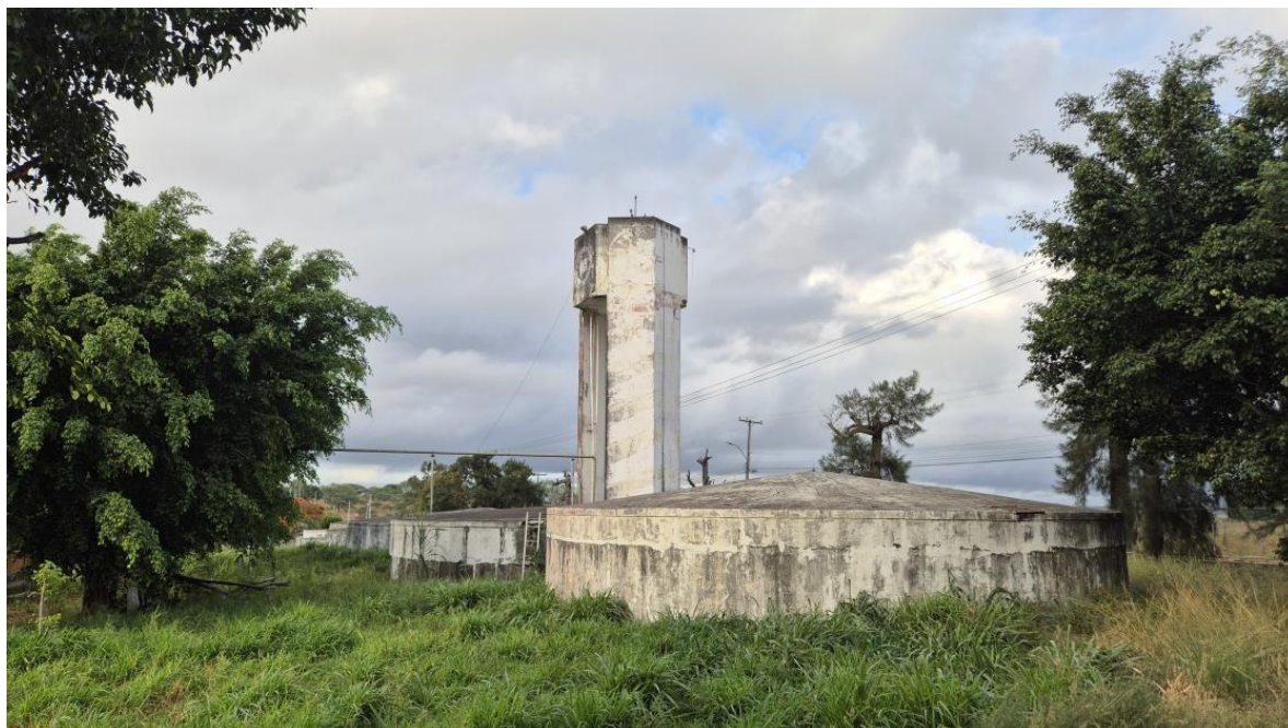
Foto 11: Reservatório de abastecimento de água potável
