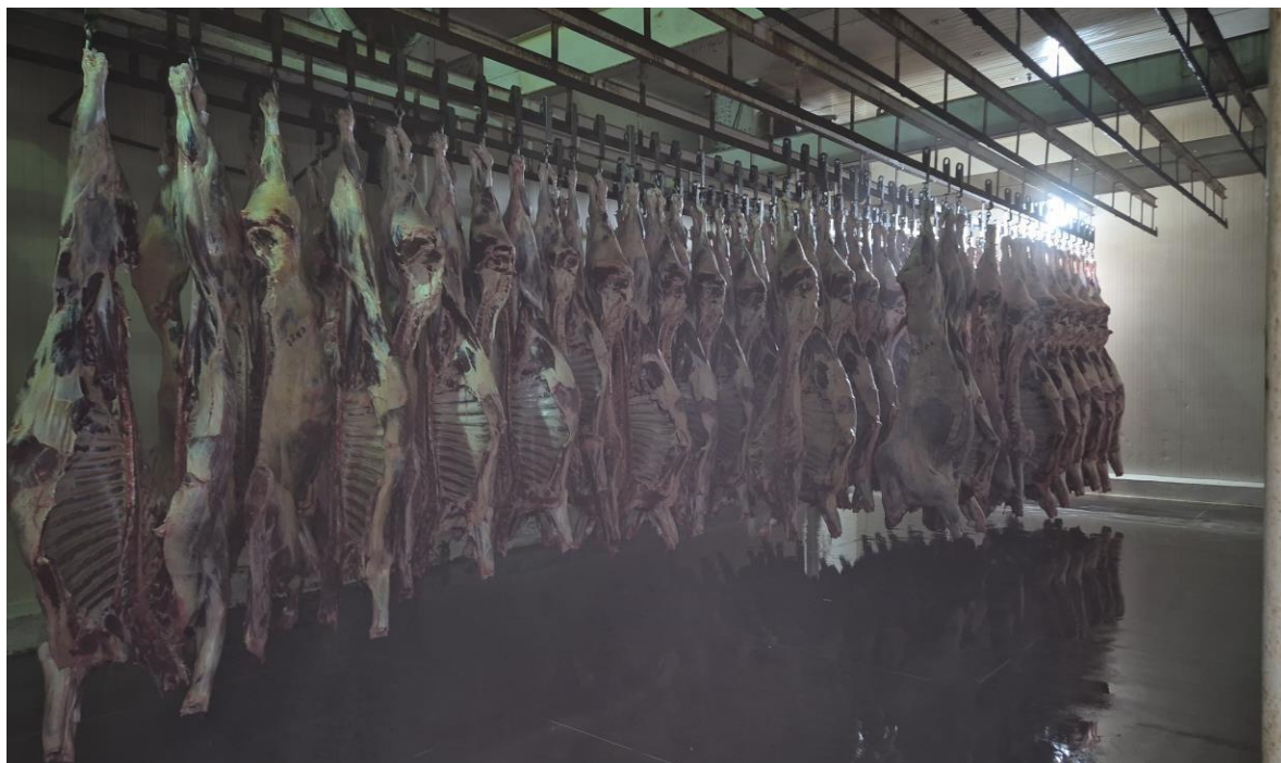
Foto 23: Câmara fria de resfriamento de carcaça
