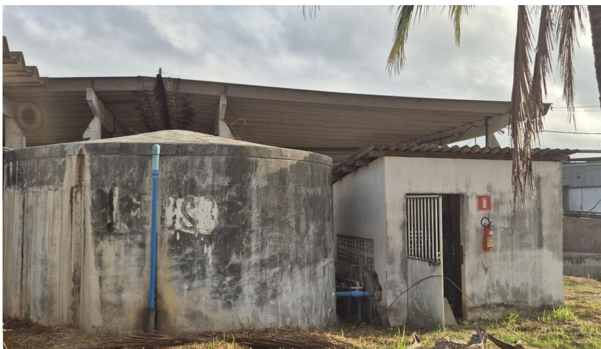
Foto 14: Sistema de abastecimento e tratamento água de reuso
