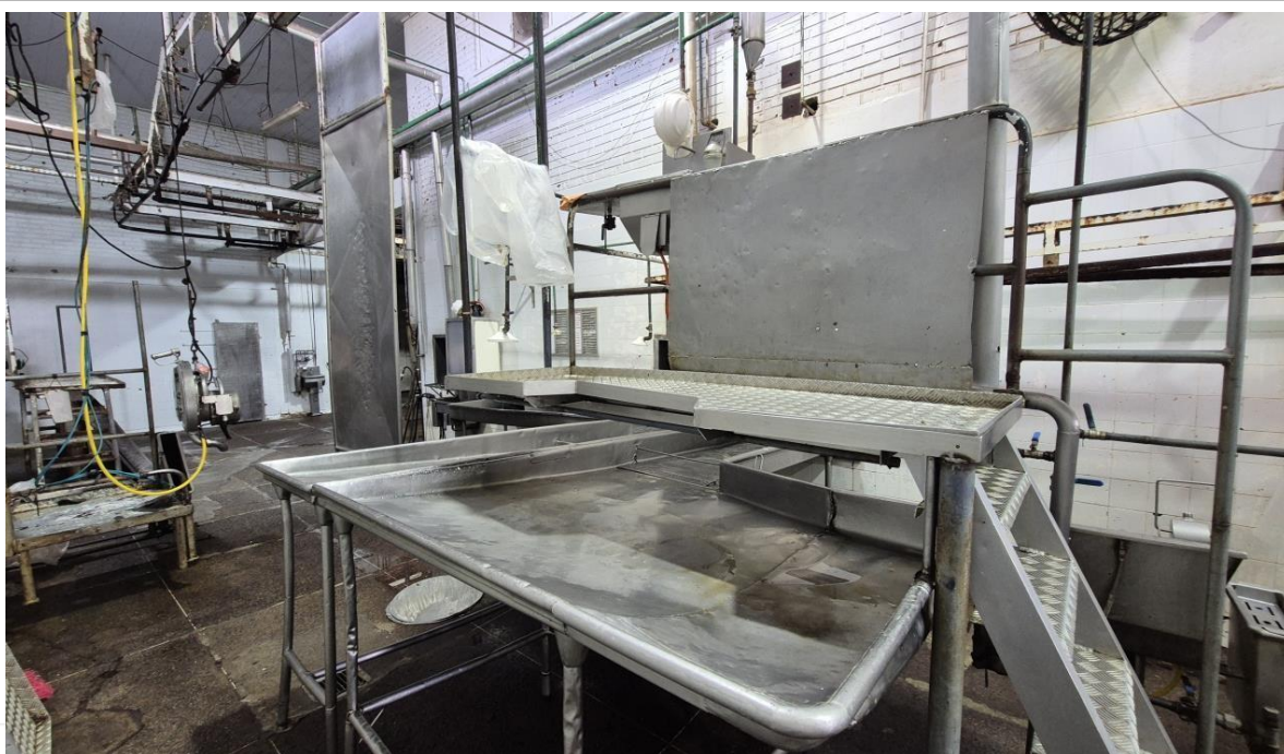
Foto 34: Sala de abate equipada (pias com esterilizadores, serras, mesas, etc.)
