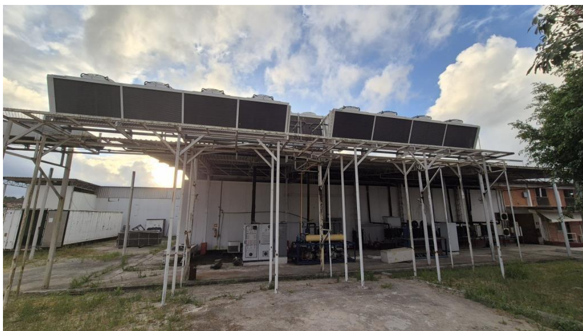
Foto 6: Sistema de frio de câmara fria
