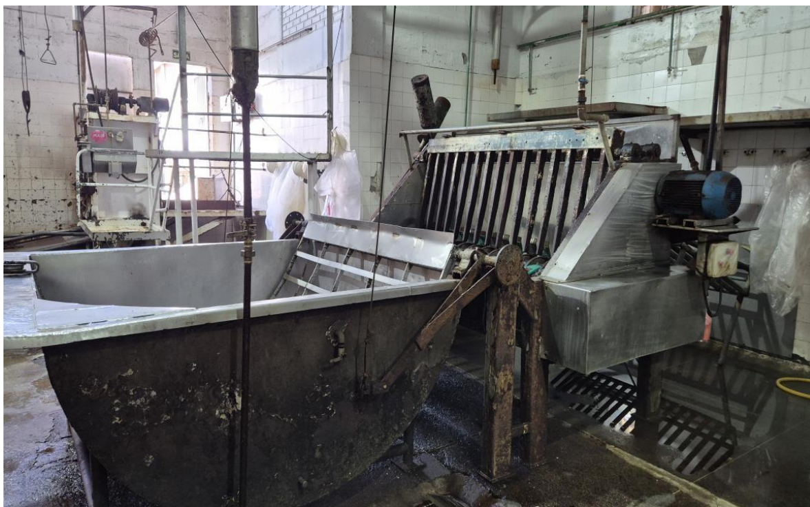
Foto 31: Sala de abate equipada (tanque de escaldagem, depiladeira, plataformas, box de insensibilização, etc.)
