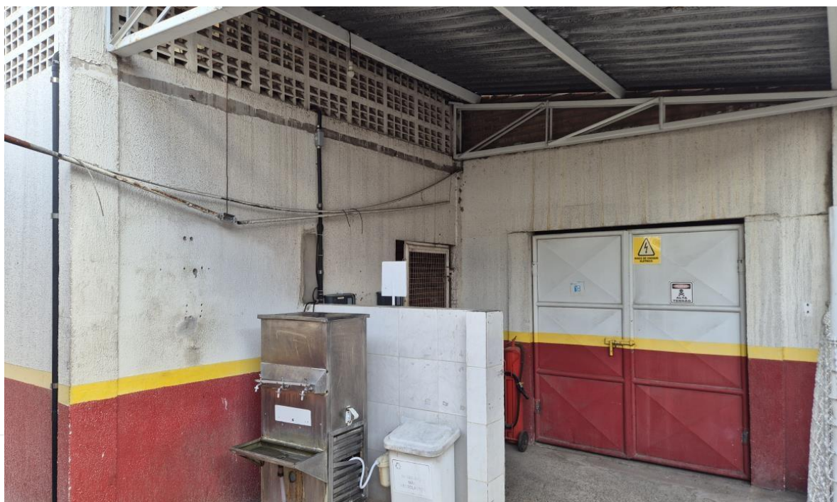
Foto 18: Sala de força e gerador
