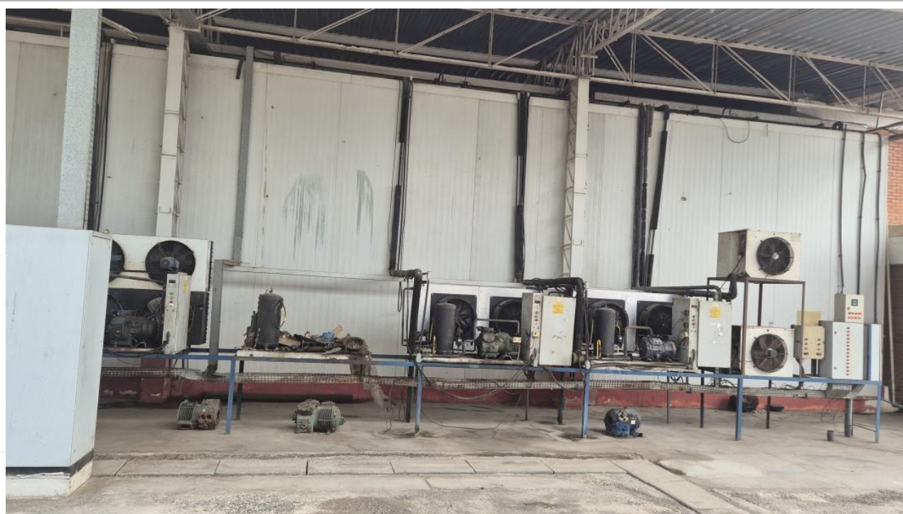
Foto 8: Sistema de frio de câmara fria
