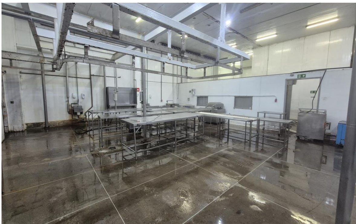
Foto 36: Sala de desossa com mesas, seladoras, sistema de frio e equipamentos diversos
