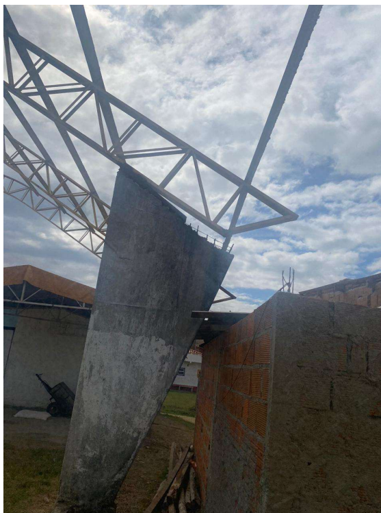
Figura 9 – Pilar com armadura exposta e descoincidência Pilar x Arco
