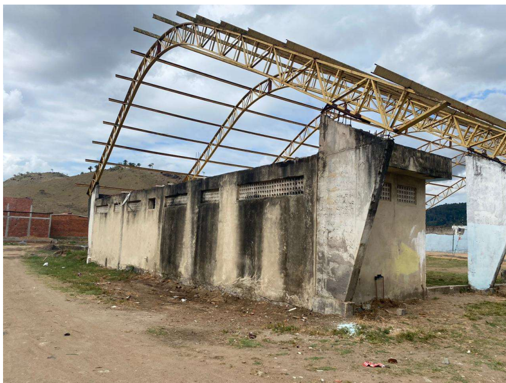
Figura 16 - Vista Vestiário e reboco apresentado infiltrações
