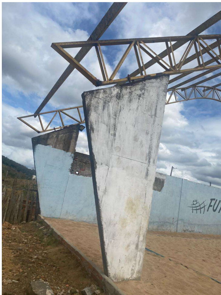
Figura 5 - Ligação Pilar x Arco descoincidente
