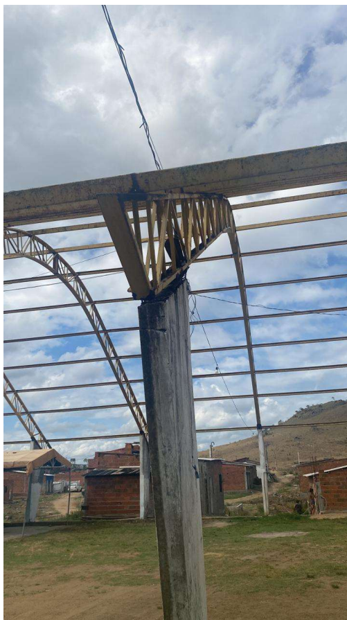
Figura 23 – Estrutura Metálica Apresentando Oxidação
