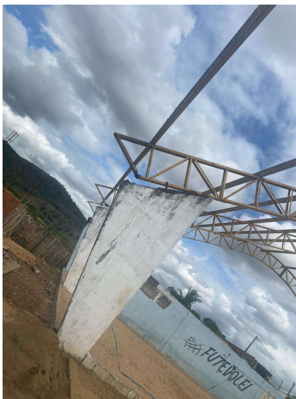
Figura 7 – Ligação pilar x Arco com descoincidência
