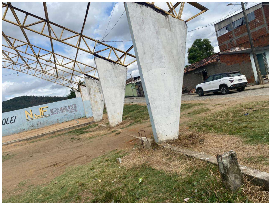
Figura 13 - Vista da Estrutura Metálica com presença de corrosão
