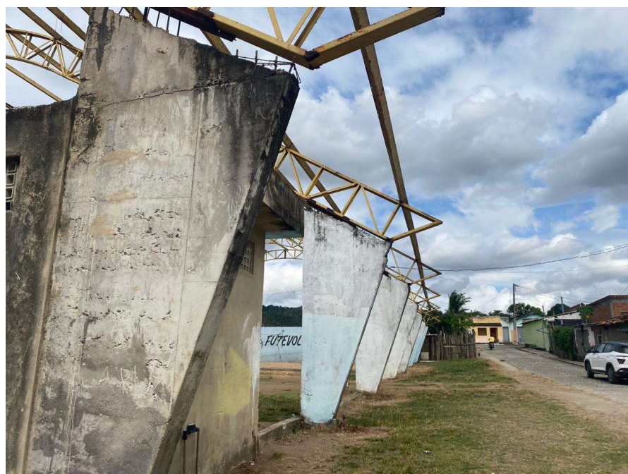
Figura 14 – Pilar com Armadura Exposta
