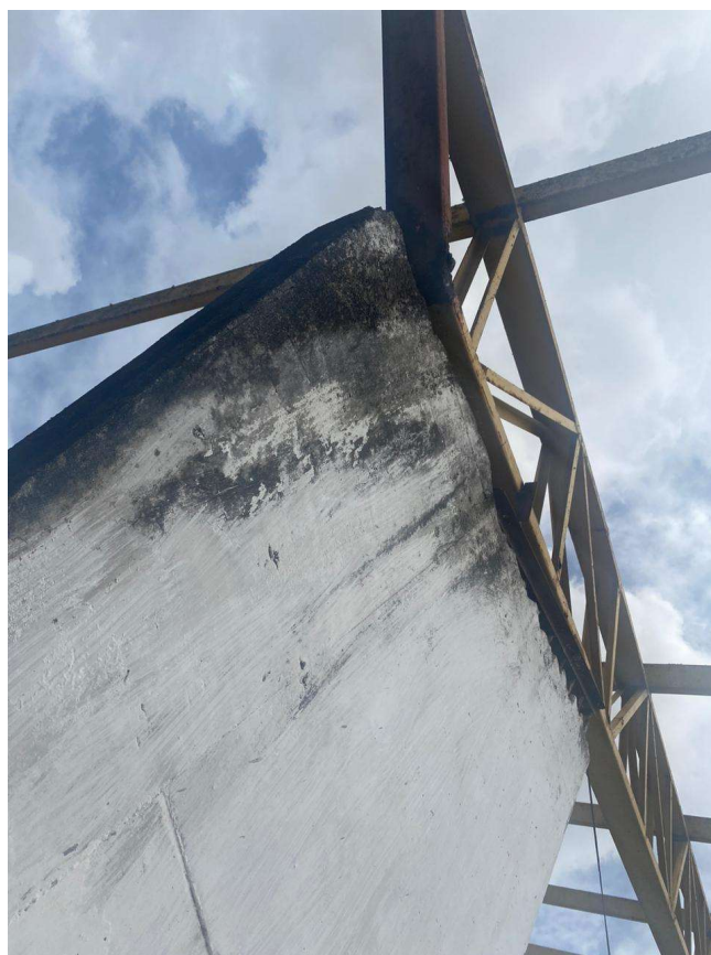
Figura 8 - Ligação Arco x Pilar apresentando corrosão
