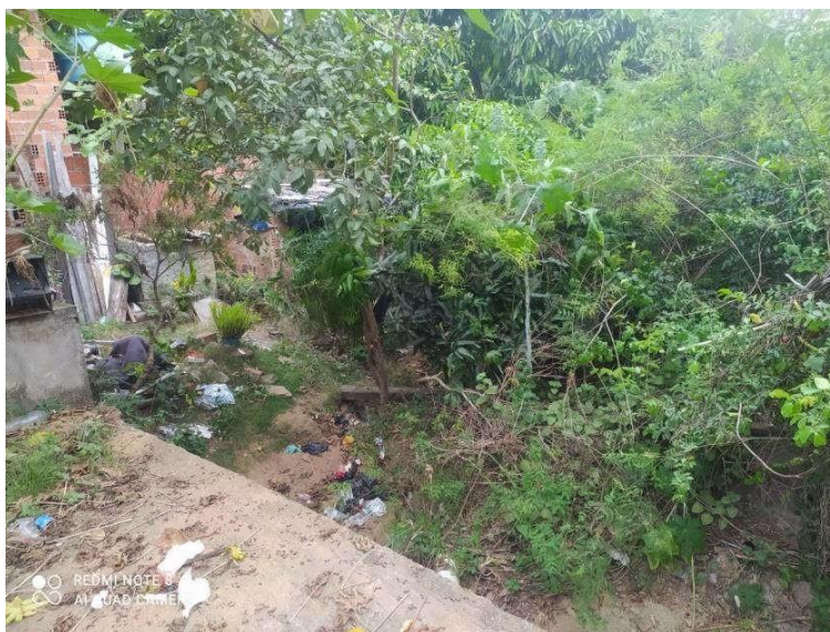
Foto 3 - Vista de entrada de águas pluviais da Região 1 situado na Rua Eduardo Teles.
