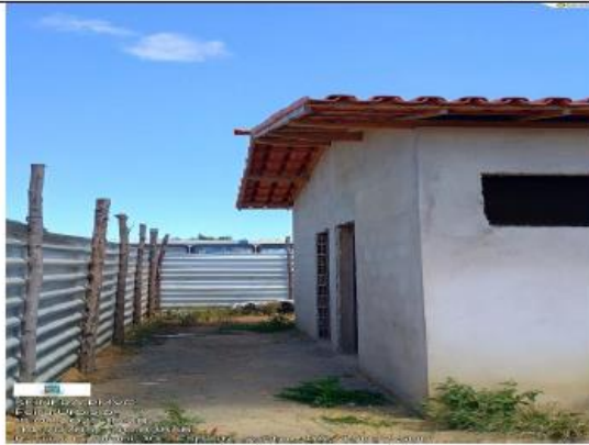
FOTO 07- LATERAL DIREITA SEM ACABAMENTO, SEM PORTAS, SEM COBOGO
