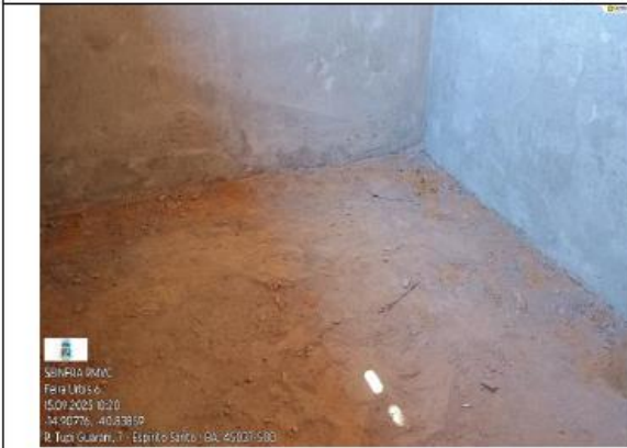
FOTO 13- INTERIOR DO SANITARIO SEM ACABAMENTO, SEM CONTRAPISO.
