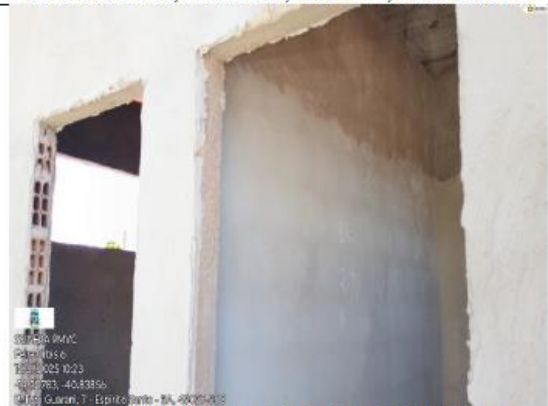
FOTO 18 –LATERAL DIREITA, SEM PORTAS, SEM REVESTIMENTO.
