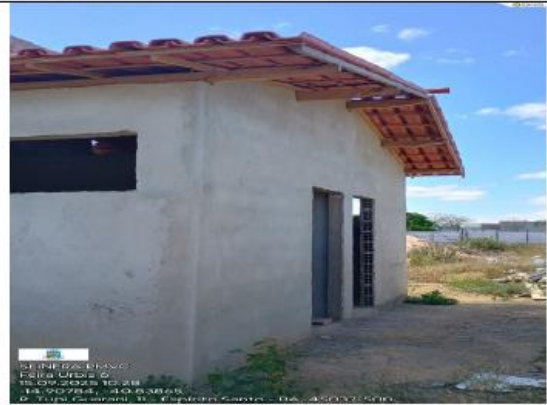
FOTO 08- LATERAL DIREITA SEM ACABAMENTO, SEM PORTAS, SEM COBOGO
