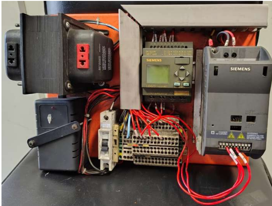
Figura 8 – Imagem Paineleletrico Elevador GI com CLP LOGO da Siemens
