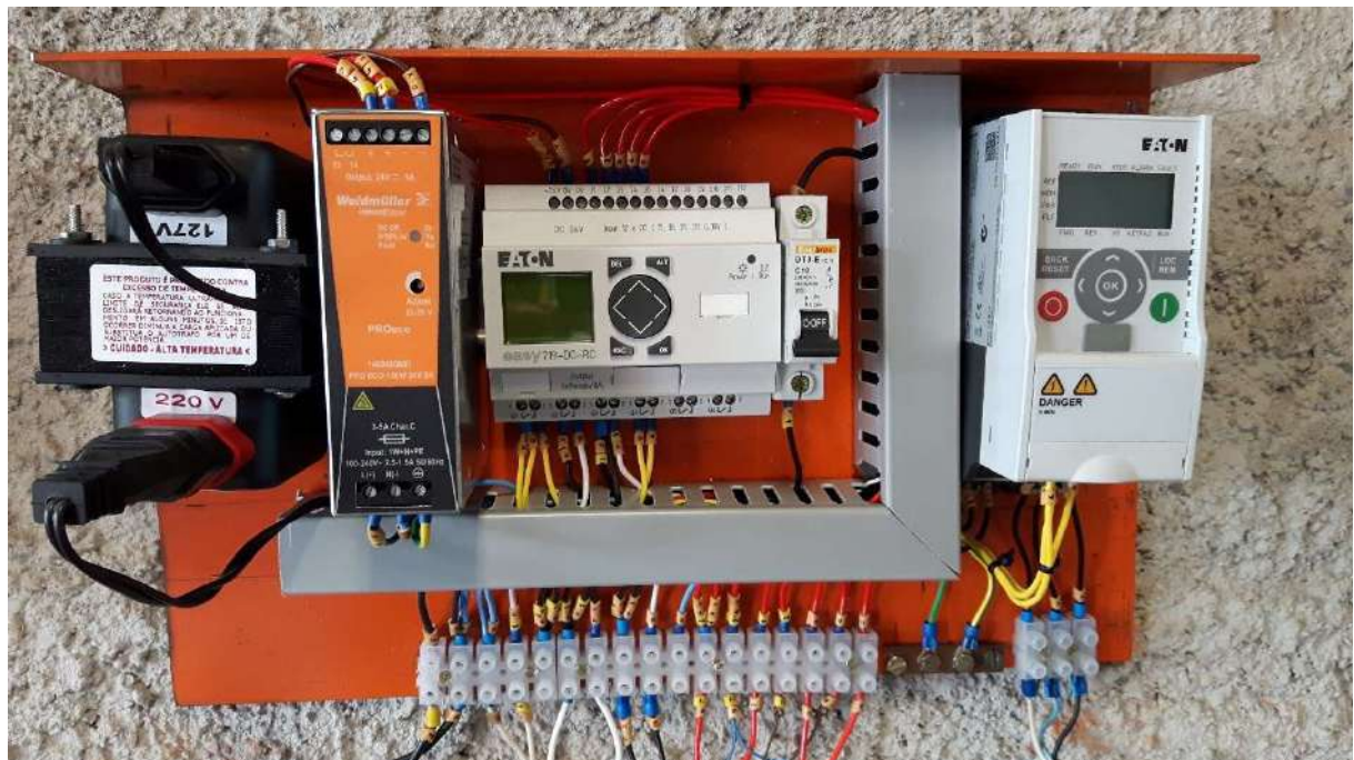
Figura 10 – Imagem Painei Elétrico Elevador GI com CLP EASY da Eaton/Moller
