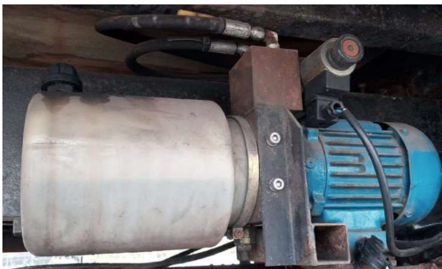
Figura 6 – Imagem sistema Óleo-Hidráulico Elevador GI
