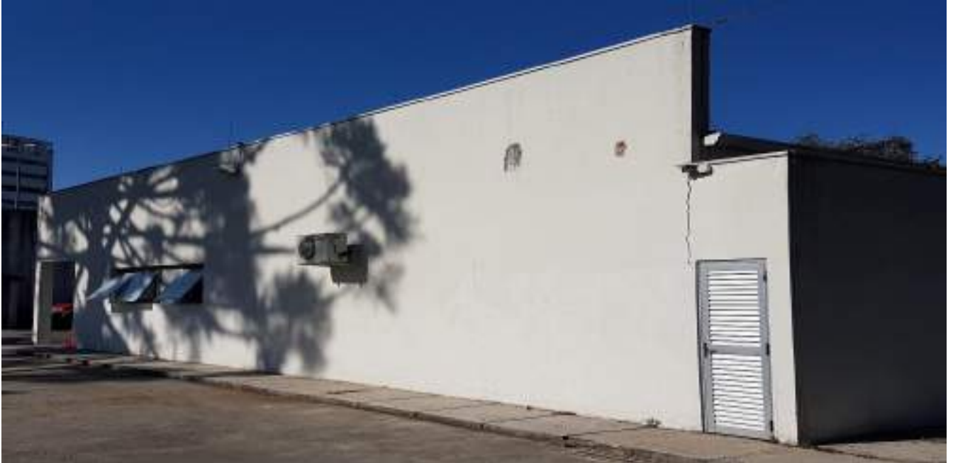
Imagem 3 - Localização: Parede do Prédio Anexo A.
