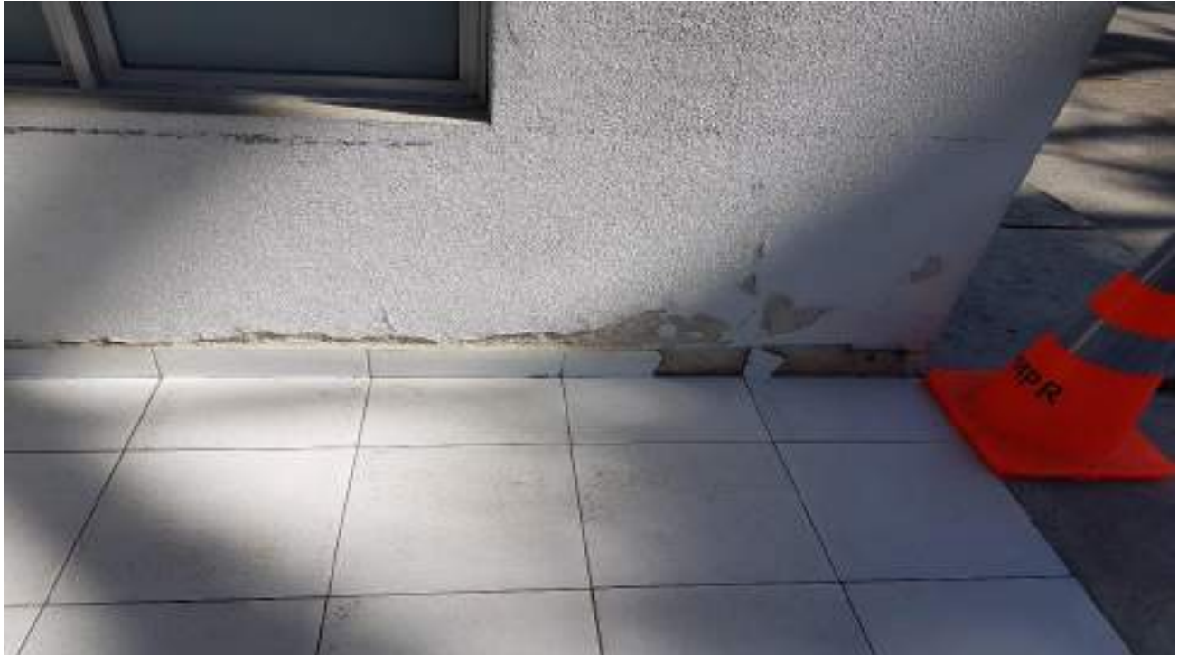
Imagem 17 - Localização: Parede lateral do Prédio Anexo A
