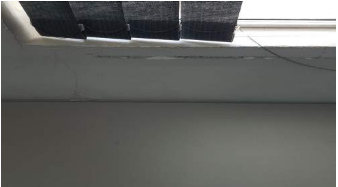
Imagem 41 - Localização: Parede da sala de descompressão (DSIPS)
