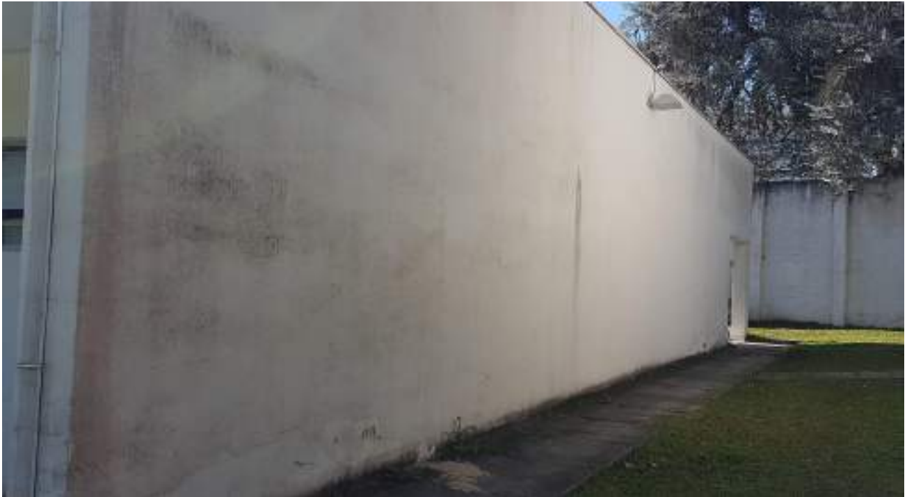
Imagem 9 - Localização: Parede do Prédio Anexo A
