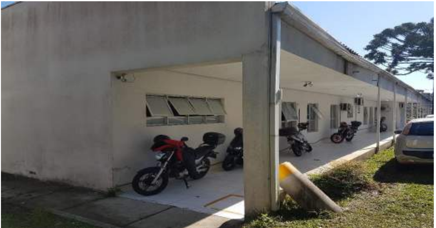
Imagem 15 - Localização: Parede lateral do Prédio Anexo A
