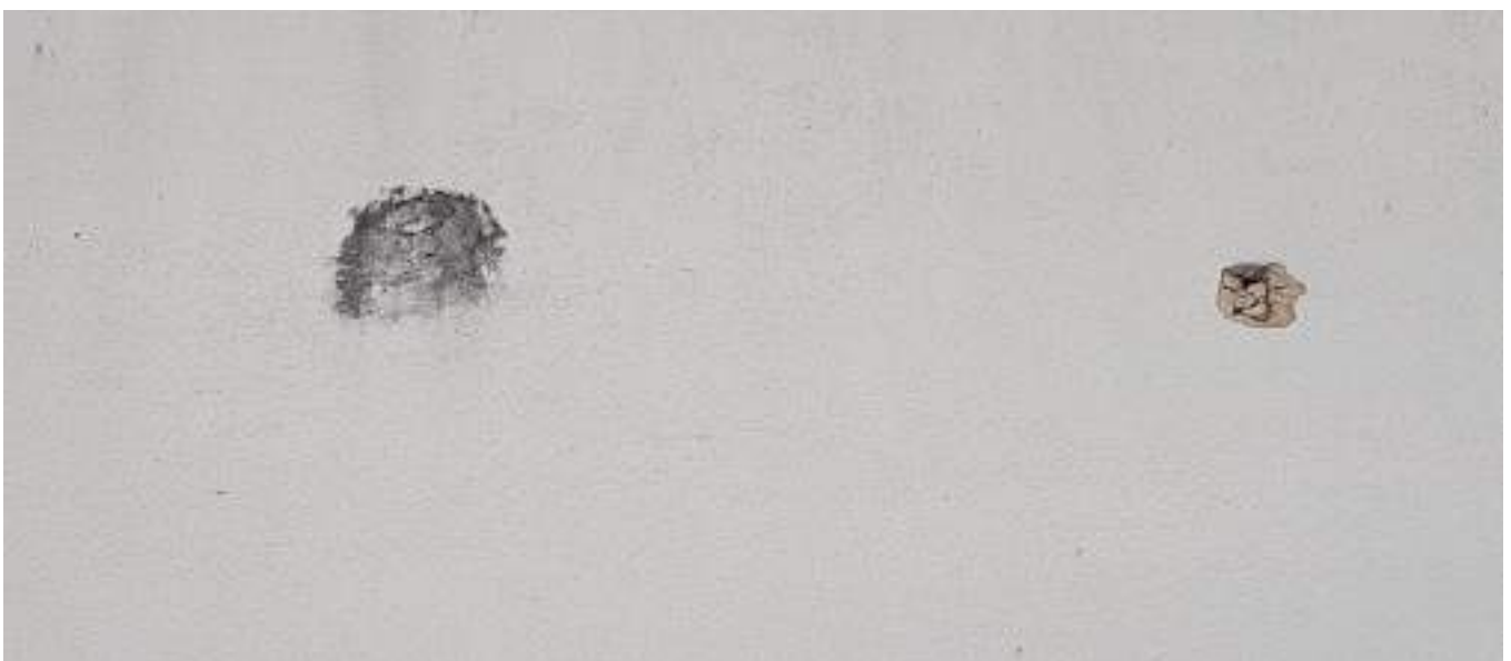
Imagem 2 - Localização: Parede do Prédio Anexo A.
