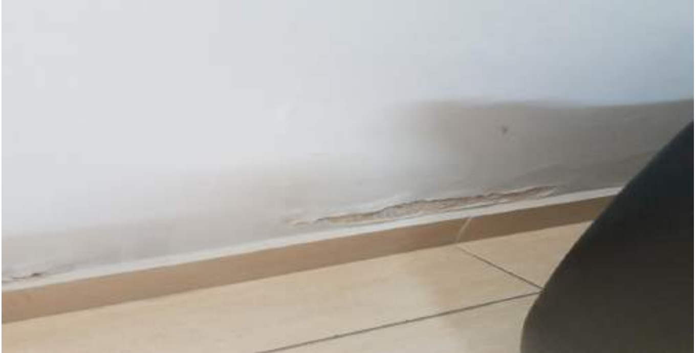
Imagem 40 - Localização: Parede da sala de descompressão (DSIPS)
