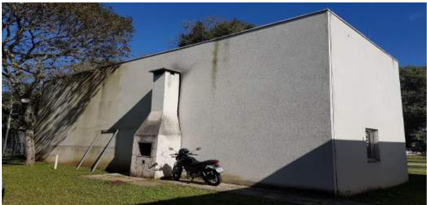
Imagem 12 - Localização: Parede fundos da garagem
