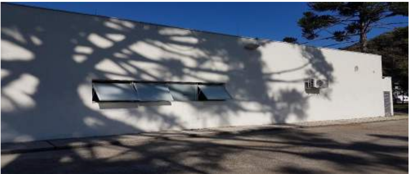
Imagem 1 - Localização: Parede do Prédio Anexo A.
